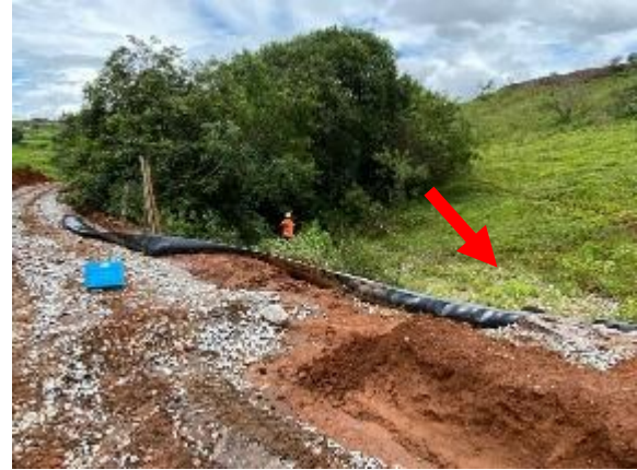
Figura 5 - Sedimentos carregados para a nascente.
