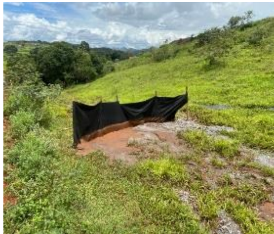
Figura 20 - Paliçada através da manta geotêxtil bidin, danificada.
