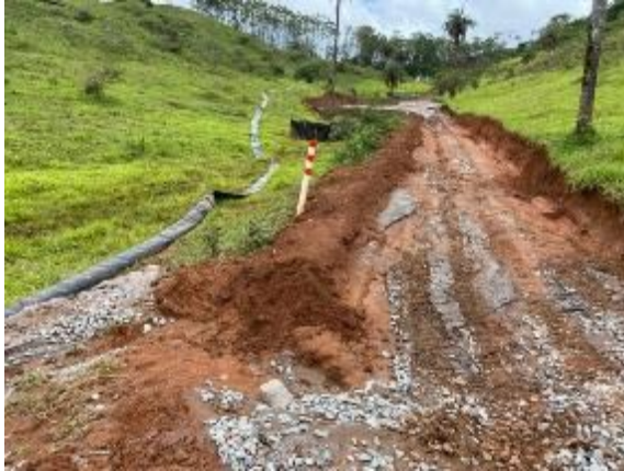
Figura 4 - Situação da leira na estrada de acesso.
