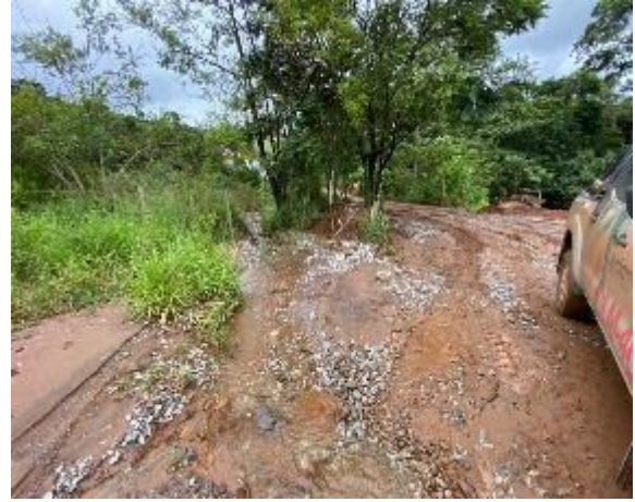
Figura 17- Fluxo D'água, descarga de fundo da lagoa 2.
