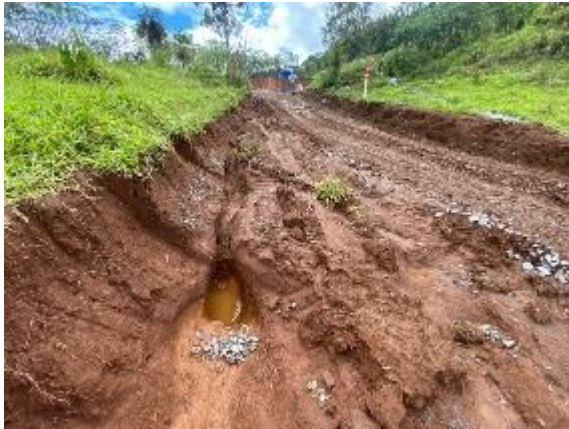
Figura 10 - Presença de ravina, acesso ao Poço 03.
