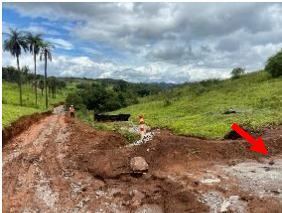
Figura 8 - A seta indica onde será instalada o poço 02, e mostra o processo de ravina na estrada de acesso.
