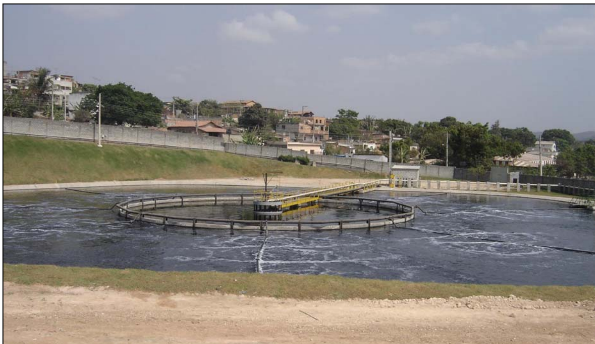
Figura 5.2 – Estação de tratamento biológico localizada na planta da empresa.
