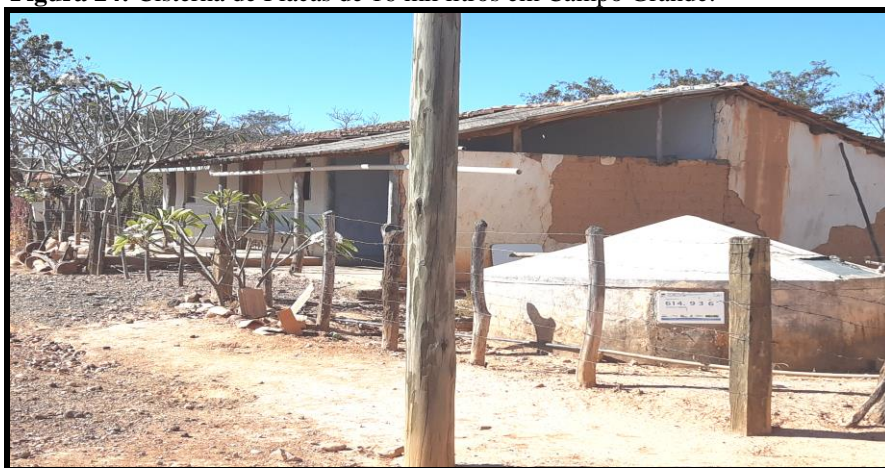
Figura 24: Cisterna de Placas de 16 mil litros em Campo Grande.
