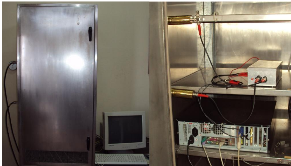
Figura 3.4 – Gabinete para blindagem do sistema de medições de corrente (Direita). Detalhe do computador e das conexões descritas na Figura 3.3 no interior do gabinete (Esquerda)
