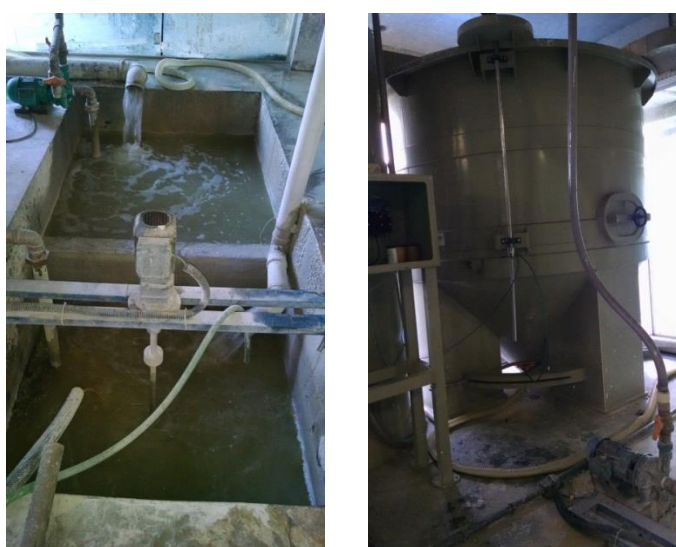
(a) tanque de agitação (b) tanque de decantação Figura 4.3 – Estação de tratamento de efluentes.
