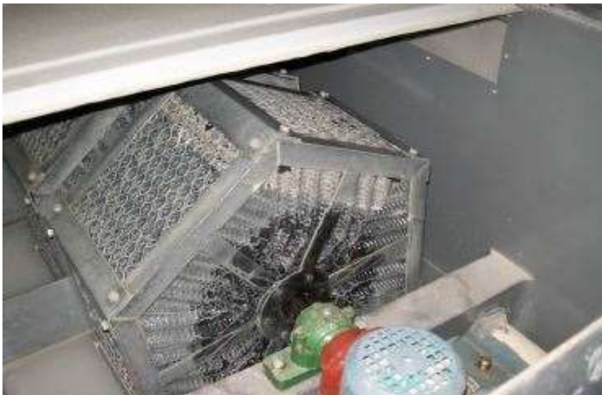
Figura 7: Estação de tratamento de águas cinzas em edifício comercial localizado na cidade de Igarassu/SP. Fonte: lavatórios. Uso: irrigação e limpeza em áreas comuns e subsolos. Utilização: 10m 3 /d.
