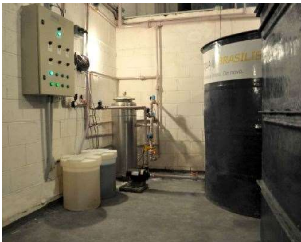
Figura 4: Estação de tratamento de águas cinzas em condomínio residencial localizado na cidade de São Paulo/SP. Fonte: chuveiros e lavatórios. Uso: descarga em vasos sanitários. Quantidade de moradores: 600. Utilização: 20m 3 /d. Fonte: Folder fornecido pela empresa Acquabrazilis.
