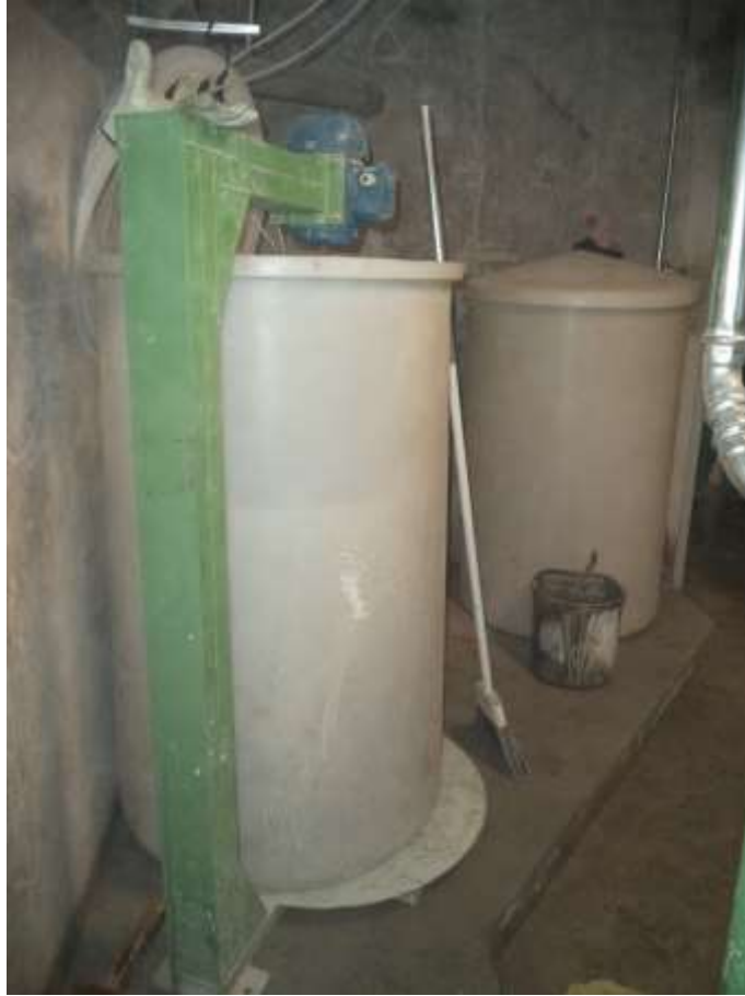
Figura 14: Sistema de dosagem de produtos químicos. Fonte: próprio autor
