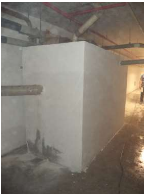
Figura 12: Reservatório inferior de águas cinzas localizado no 5º subsolo. Fonte: próprio autor
