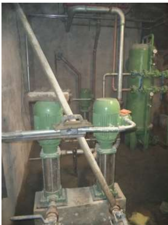
Figura 13: Sistema de filtração em areia. Fonte: próprio autor
