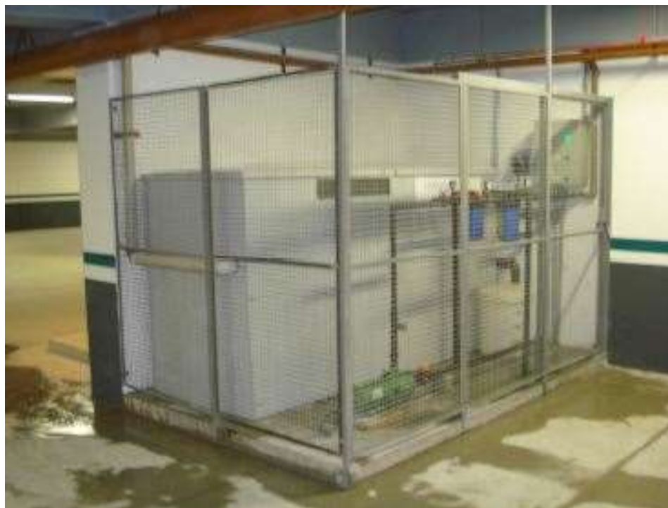
Figura 6: Estação de tratamento de águas cinzas em edifício comercial localizado na cidade de Igarassu/SP. Fonte: lavatórios. Uso: irrigação e limpeza em áreas comuns e subsolos. Utilização: 10m 3 /d. Fonte: Folder fornecido pela empresa Acquabrazilis.
