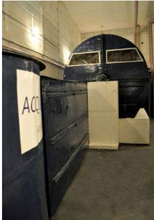
Figura 5: Estação de tratamento de águas cinzas em condomínio residencial localizado na cidade de São Paulo/SP. Fonte: chuveiros e lavatórios. Uso: descarga em vasos sanitários. Quantidade de moradores: 600. Utilização: 20m 3 /d. Fonte: Folder fornecido pela empresa Acquabrazilis.
