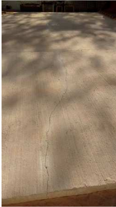
Figura 9. Fissura transversal no meio da placa.
