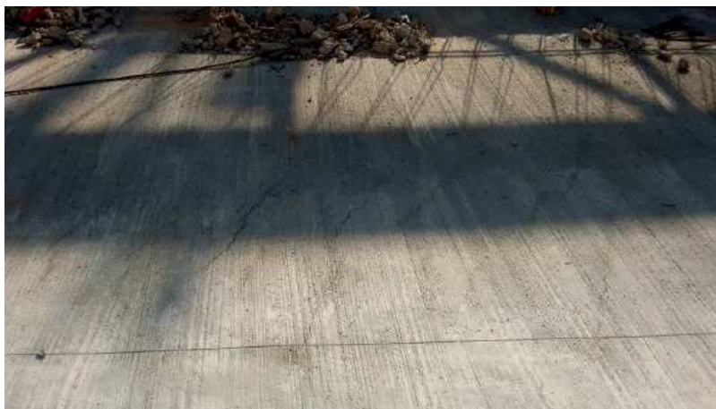
Figura 4. Fissuras lineares por acomodação do concreto.
