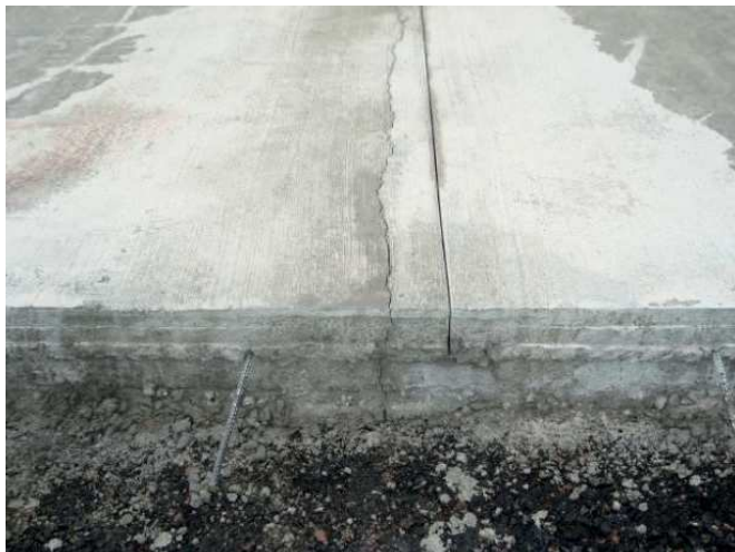
Figura 1. Surgimento de fissura devido ao atraso de corte.
