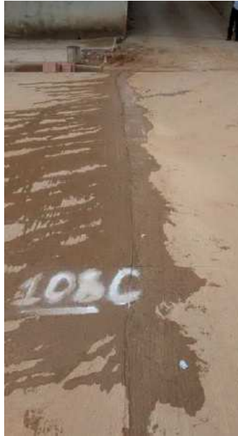
Figura 8. Junta de construção com provável movimentação de fôrma.
