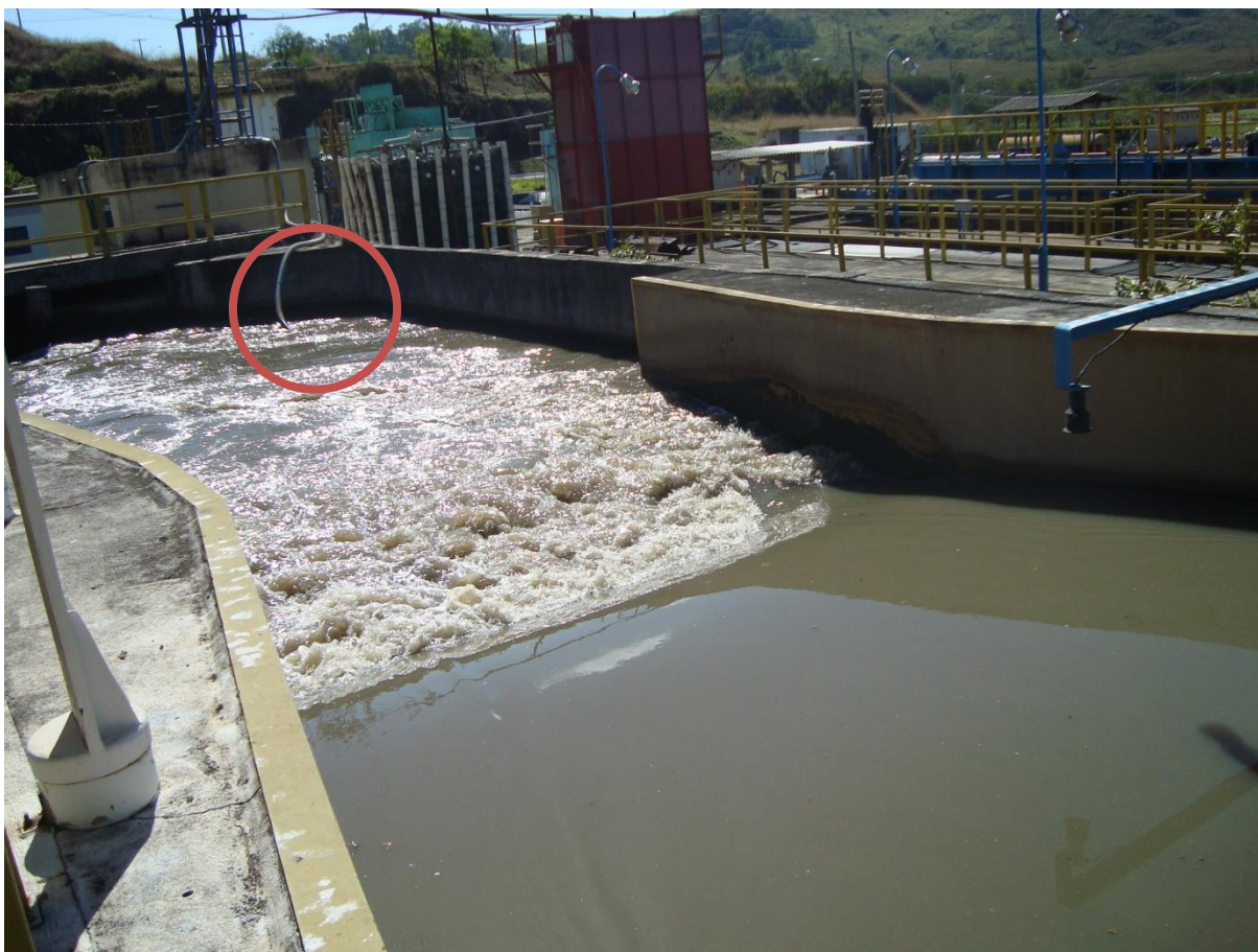
Figura 4.2: Ponto de captação do esgoto que alimenta o SAC
