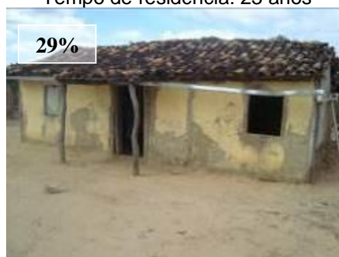
FIGURA 4.28: Domicílio com estrutura em condição ruim. Município de Januária, Norte de Minas – UGM CAR Tempo de residência: 50 anos
