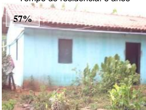
FIGURA 4.35: Domicílio com cobertura em condição boa. Município de Jenipapo de Minas, Vale do Jequitinhonha – UGM CAV. Tempo de residência: 10 anos.
