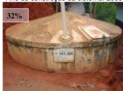
FIGURA 4.58: Cisterna com condição de pintura ruim. Município de Minas Novas, Vale do Jequitinhonha – UGM CAV Ano de construção da cisterna: 2005
