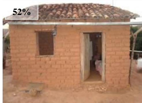
FIGURA 4.32: Domicílio com cobertura em condição ruim. Município de Taiobeiras, Norte de Minas – UGM CAA. Tempo de residência: 37 anos.
