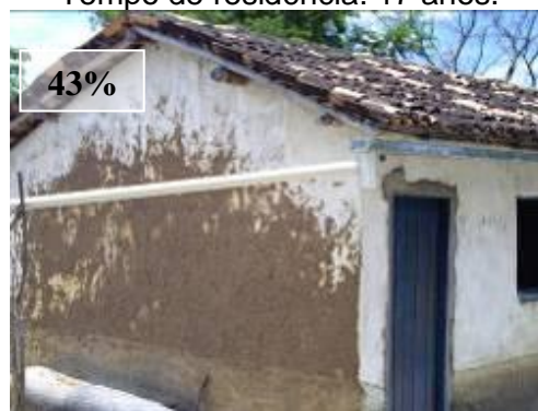
FIGURA 4.36: Domicílio com cobertura em condição ruim. Município de Itaobim, Vale do Jequitinhonha – UGM CAV. Tempo de residência: 9 anos.
