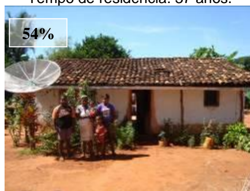
FIGURA 4.34: Domicílio com cobertura em condição ruim. Município de Bonito de Minas, Norte de Minas – UGM CAR. Tempo de residência: 17 anos.
