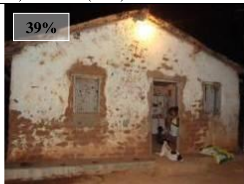
FIGURA 4.26: Domicílio com estrutura em condição ruim. Município de Pai Pedro, Norte de Minas – UGM CAA Tempo de residência: 23 anos
