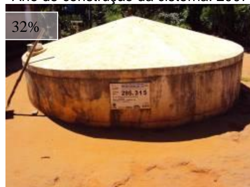
FIGURA 4.56: Cisterna com condição de pintura ruim. Município de Januária, Norte de Minas – UGM CAR Ano de construção da cisterna: 2009
