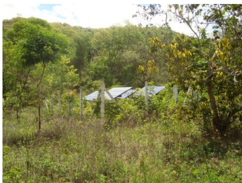
FIGURA 4.38: Dispositivo de aproveitamento de energia solar abandonado na área rural do município de Chapada do Norte. 11/2009.
