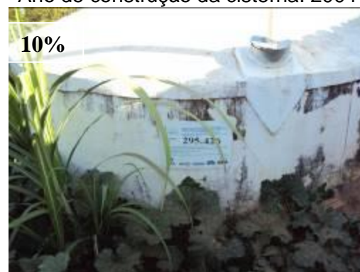
FIGURA 4.62: Cisterna com condição de entorno ruim. Município de Itacarambi, Norte de Minas – UGM CAR. Ano de construção da cisterna: 2009
