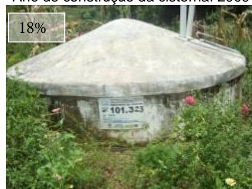
FIGURA 4.64: Cisterna com condição de entorno ruim. Município de Araçuaí, Vale do Jequitinhonha – UGM CAV. Ano de construção da cisterna: 2005
