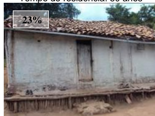
FIGURA 4.30: Domicílio com estrutura em condição ruim. Município de Virgem da Lapa, Vale do Jequitinhonha – UGM CAV. Tempo de residência: 36 anos.
