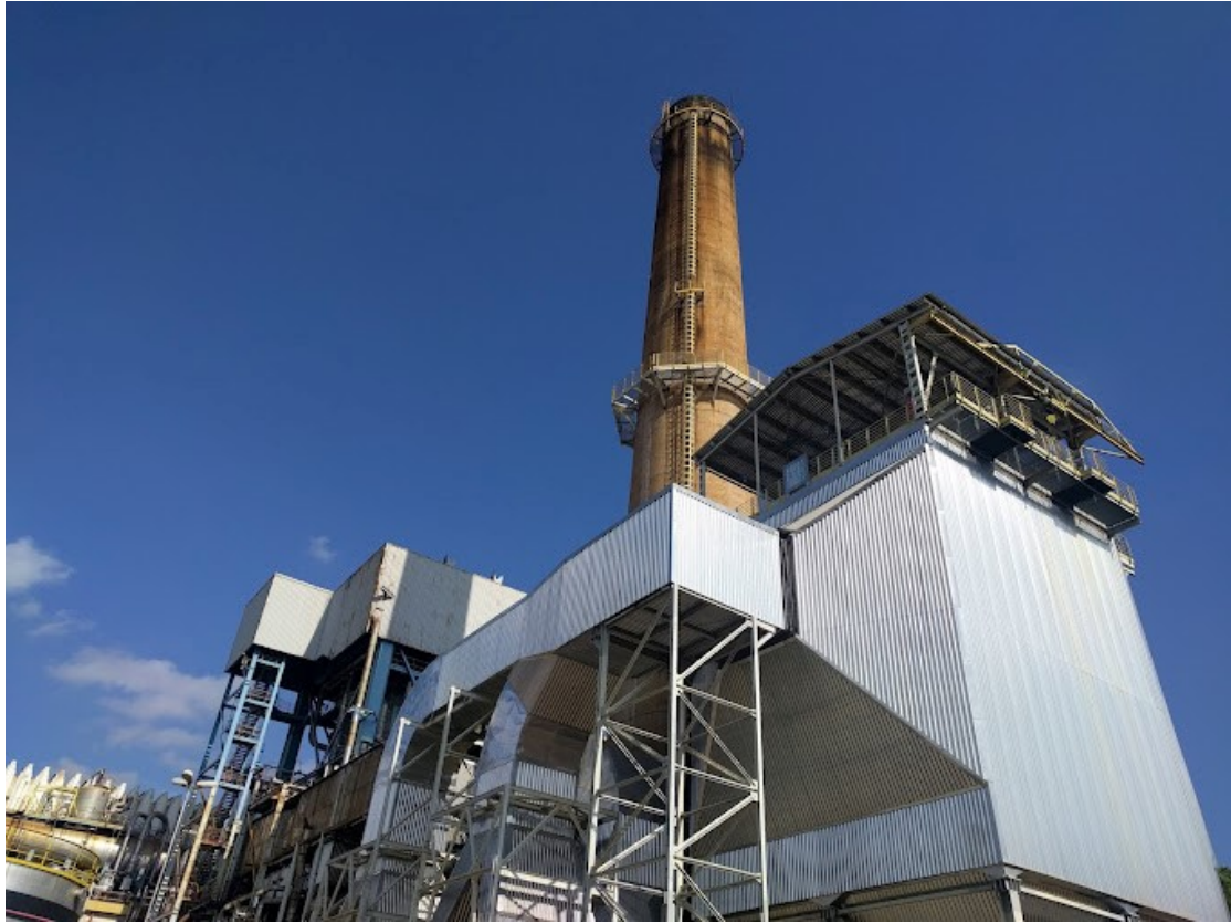
FIGURA 1.1: Usina Termoeletrica de Igarapé: CEMIG.
