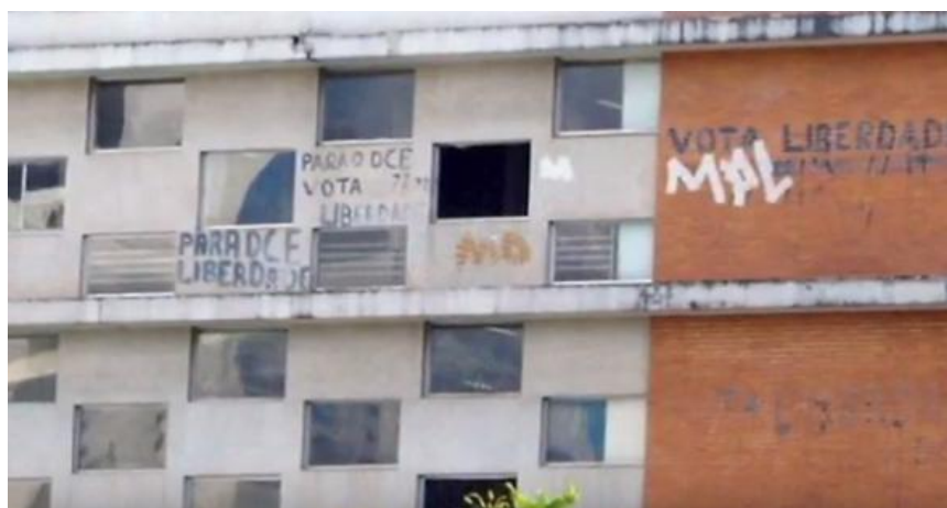
Figura 67 – Pichações do edifício da antiga FAFICH
