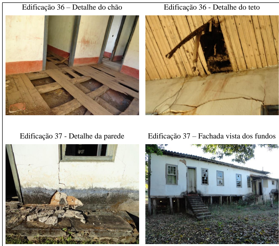
Figura 36 - Detalhes de residências sem reforma
