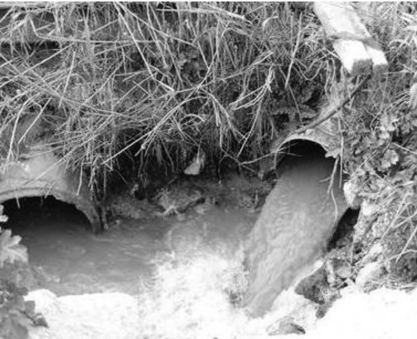
FIGURA 5.4. Lançamento de Egotos na Água 13 .
