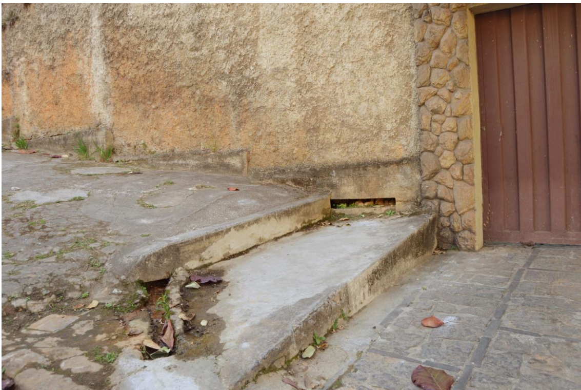
Figura 10: Fotografia do ponto onde a mina d'água alcança a rua.
