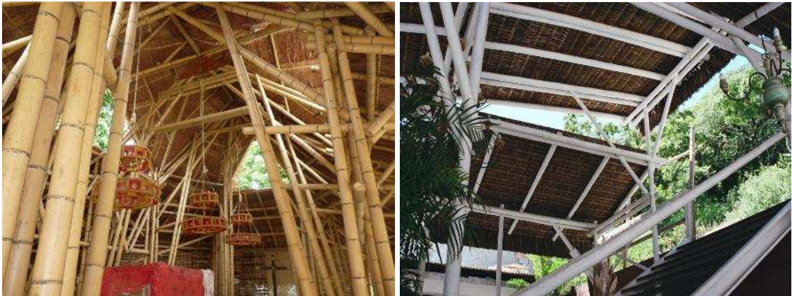
Figura 2.33: Estruturas parafusadas construídas pela Arte Desenho Oficina de Design. (Arquivo pessoal Prof. Luís Eustáquio)
