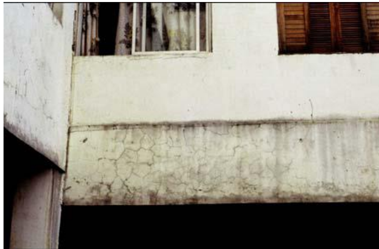
Figura 25 - Fissuras de retração em concreto armado, causadas pela elevadíssima quantidade de cimento e/ou relação água/cimento do concreto.
