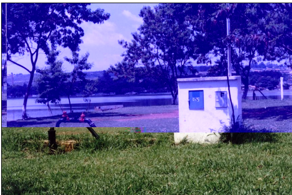
Figura 9.2 - Poço tubular localizado na várzea da Lagoa Santa.
