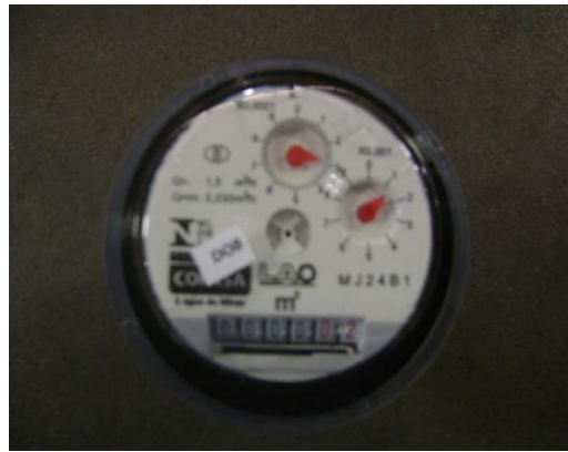
FIGURA 6: Dispositivo totalizador de volume de água
