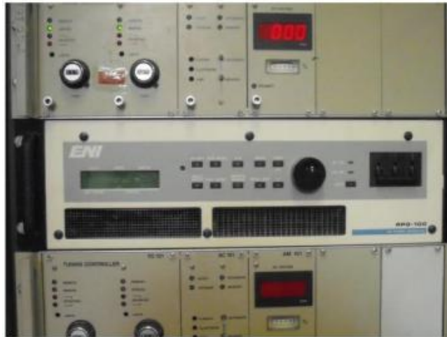
Figura 2-10 Gerador de Plasma RPG-100 instalado no rack do sistema BAS450
