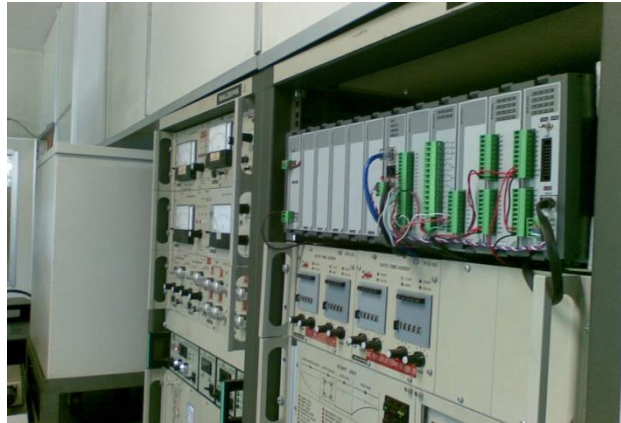
Figura 3-13 PLC instalado no Rack da BAS450
