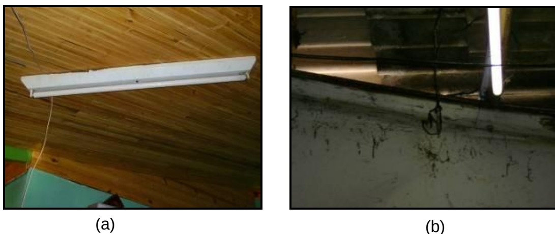
Figura I.11: Instalações elétricas e luminárias verificadas nos ambulantes de alimentos prontos para consumo em Ouro Preto-MG: (a) Ambulante 8 (b) Ambulante 9.
