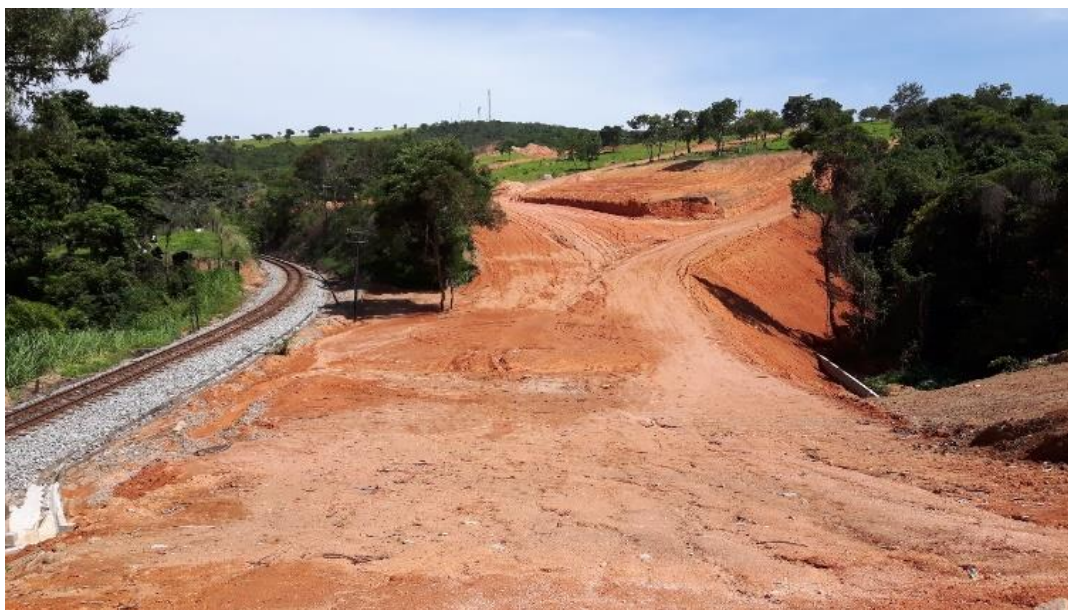
Figura 4-4: Ação Antrópica, remoção de cobertura vegetal
