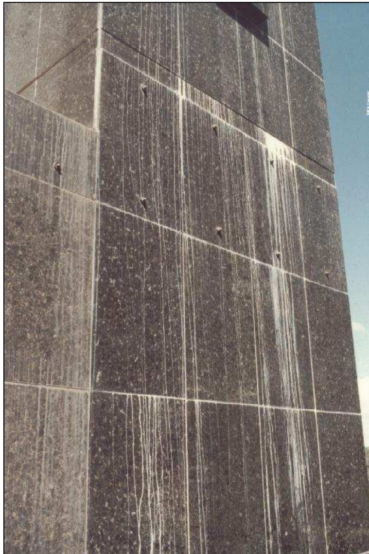
Foto 3.12: Nesta fachada (tipo Granito Verde Ubatuba – charnockito) ocorrem eflorescência, mudança de coloração, alteração do hiperstênio (mineral de alta temperatura de formação) e manchamento pela oxidação dos elementos metálicos fixadores. Nesta mesma fachada ocorreram quedas de placas, causando danos materiais na área externa comum (localização: edifício comercial no município de Nova Lima-MG).
