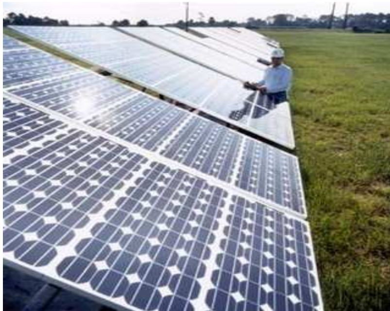
Figura 3.2 - Painéis fotovoltaicos, que convertem energia solar em eletricidade.
