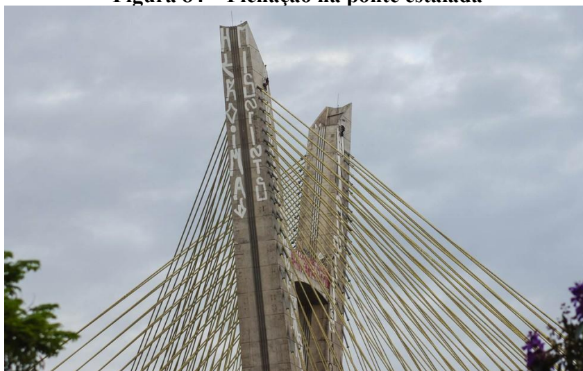
Figura 84 – Pichação na ponte estaiada
