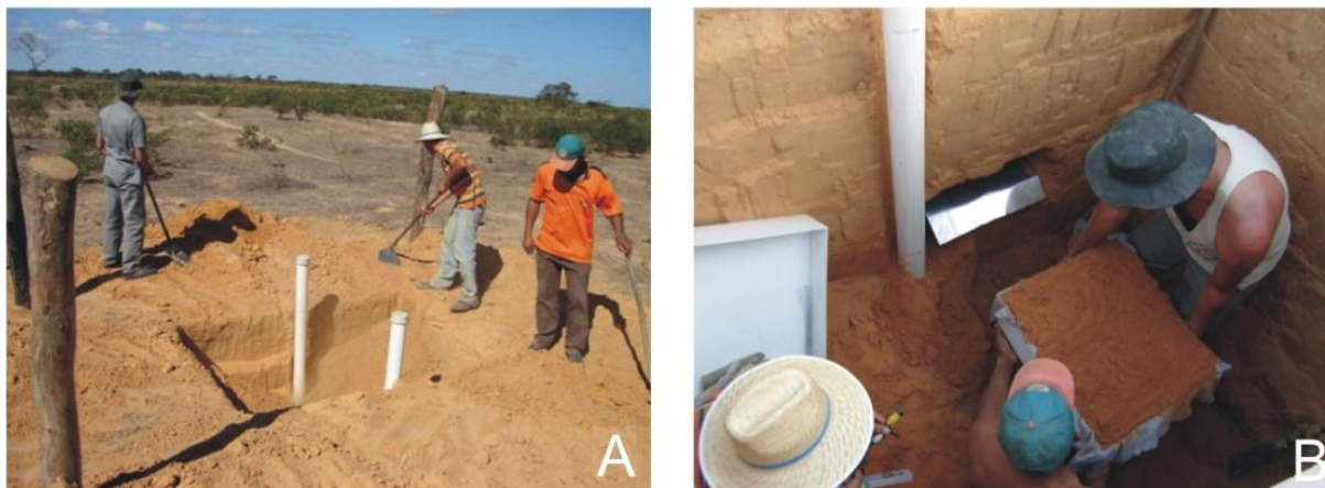
Figura 3: Instalação de infiltrômetro: A– Escavação da trincheira para a instalação das caixas coletoras de água; B – Colocação das caixas coletoras em nichos criados no solo.
