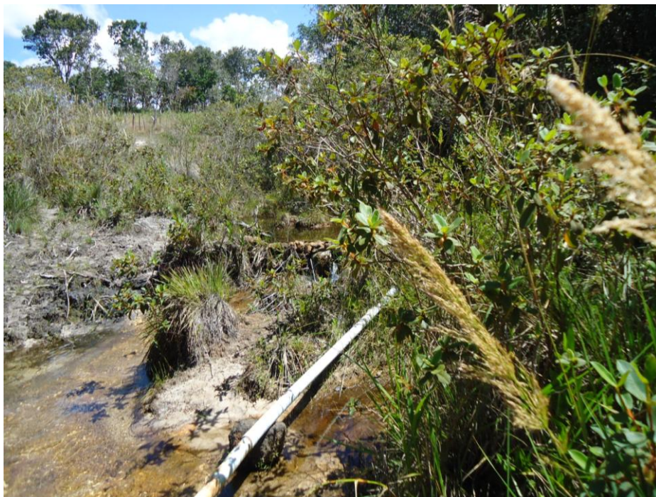
FIGURA 5 – Captação de água da vereda, por meio de uma tubulação Fonte: Arquivo pessoal do autor
