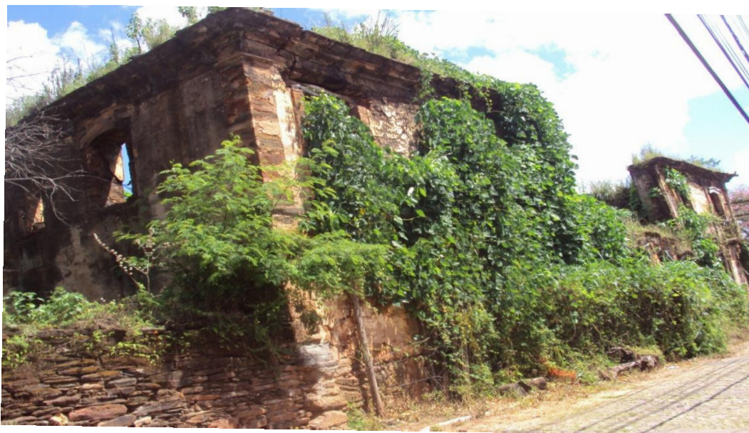
Figura 4: Solar Melo Viana após obras de escoramento – Em 05/03/2012
