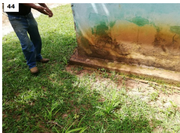
Figura 16: Registros de lama oriunda de obra na região do Retiro afetando casa de morador.
