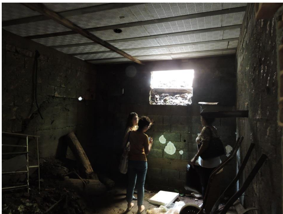
Figura 51 – Quarto de Beatriz com manchas brancas de mofo na parede.
