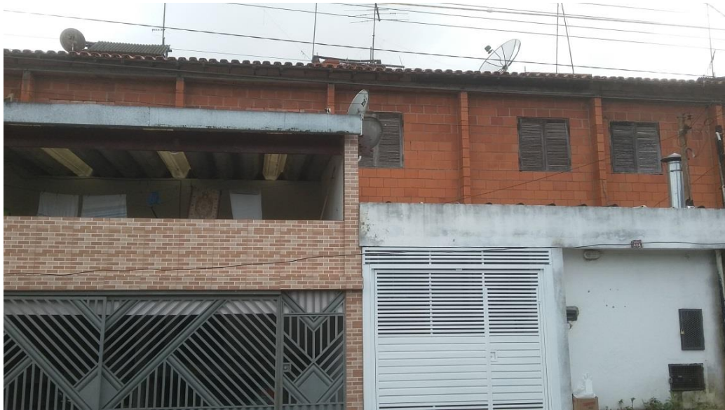
Figura 2 - Adaptações externas realizadas por moradores de Conjunto Habitacional Cazuzu em Diadema, São Paulo. As áreas representadas por tijolo cerâmico estrutural são as originais do projeto – as demais são intervenções.
