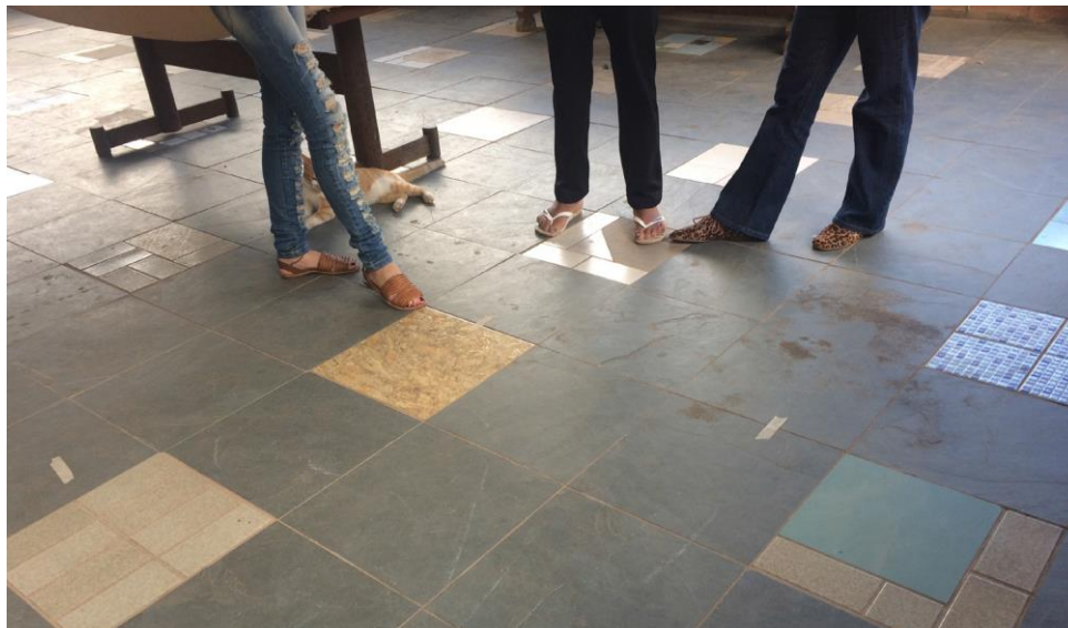
Figura 54 – Trincas no piso da laje de cobertura da moradia de Dona Efigênia
