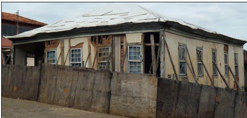
Figura 14 - Imóvel pouco antes de desabar, com pau a pique aparente e escorado
