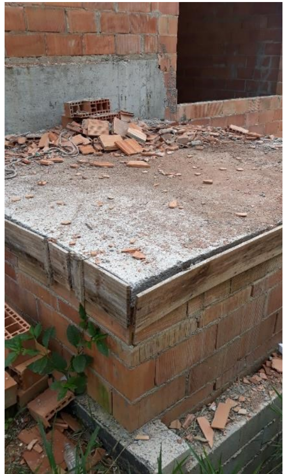
Figura 2– Desperdício de blocos estruturais no canteiro – Fonte: arquivo do autor
