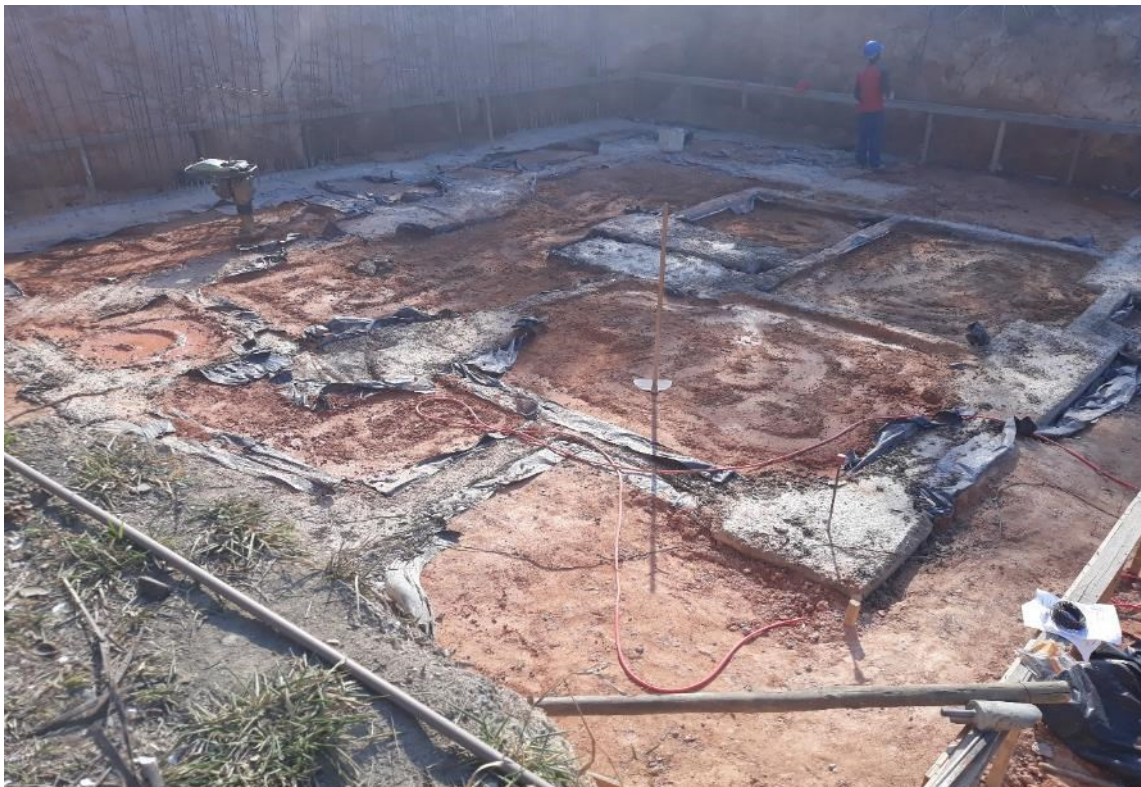
Figura 5 – Fundação com blocos de coroamento e vigas baldrame. Fonte: Arquivo do autor
