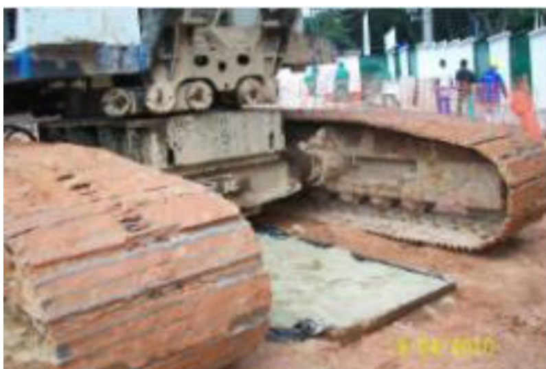
Foto 13 - Controle da contaminação do solo: bandeja de contenção de vazamentos
