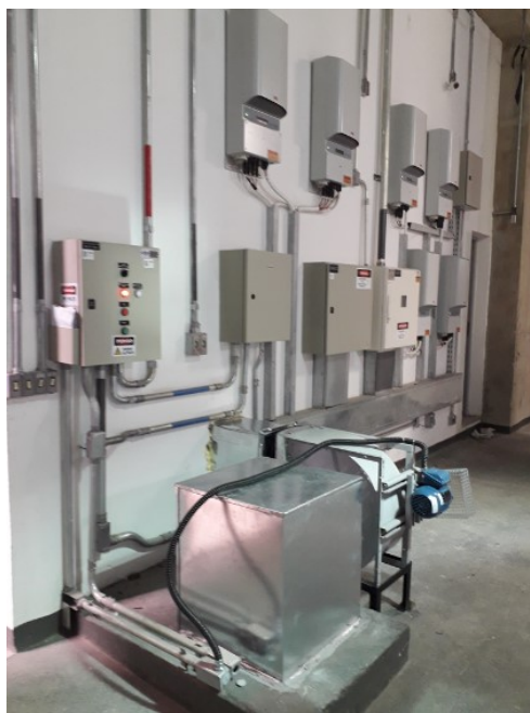
Foto 29 - Otimizar eficiência energética 21%: sistema de inversores do sistema fotovoltaico
