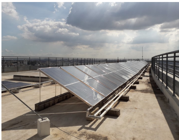
Aquecimento solar de água Atende: Cozinha e vestiários. 70 Placas e 3 Boilers de 4 mil litros cada. Fonte: A autora, 2019.
