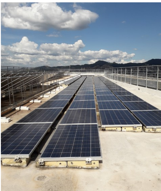
Foto 28 - Otimizar eficiência energética 21%: placas de geração fotovoltaica
