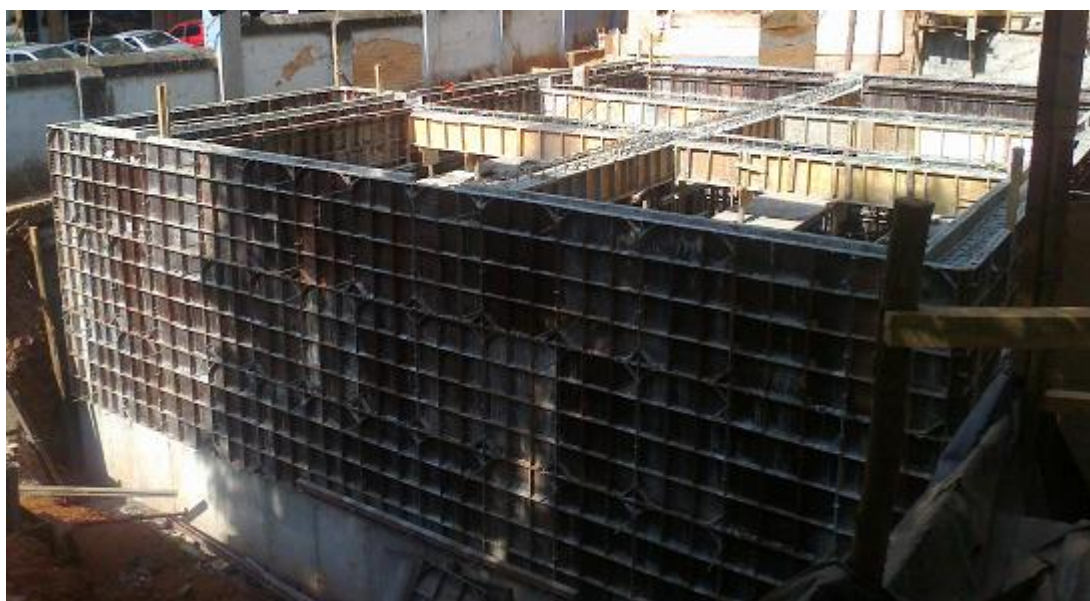
Figura 4.6 - Caixa de retenção construída em concreto armado
