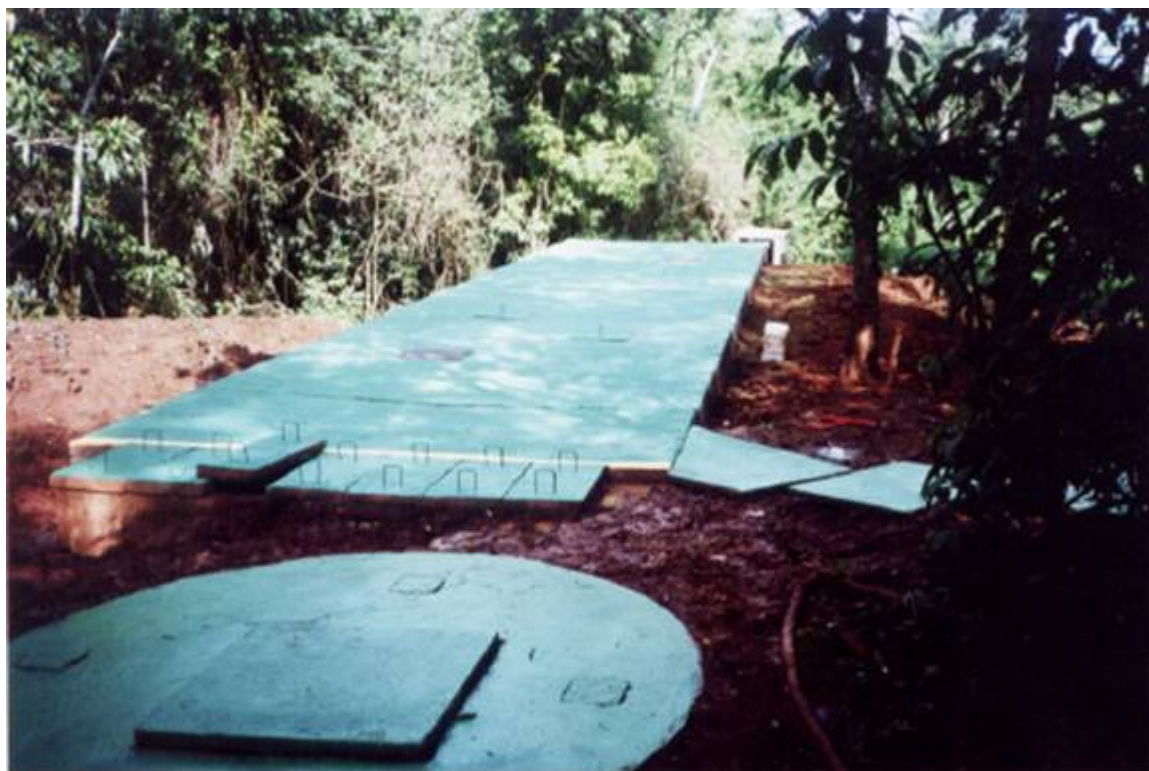
Figura 15: Estação de tratamento de efluentes do Hotel. Fonte: Hotel Tropical das Cataratas, 2004.
