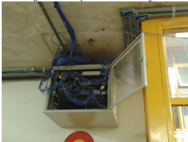
Figura 5: Instalação elétrica exposta.
