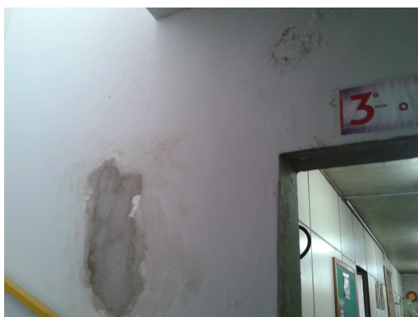
Figura 2: Revestimento interno danificado.
