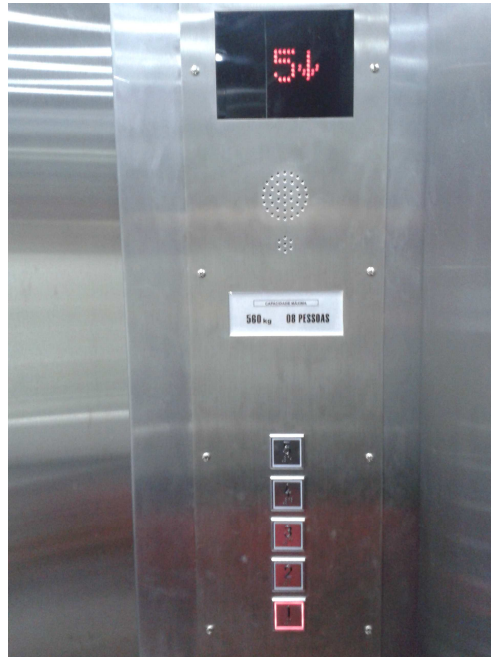
Figura 11: Elevador instalado em junho/2014.
