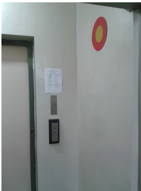
Figura 10: Sinalização de emergência inadequada.
