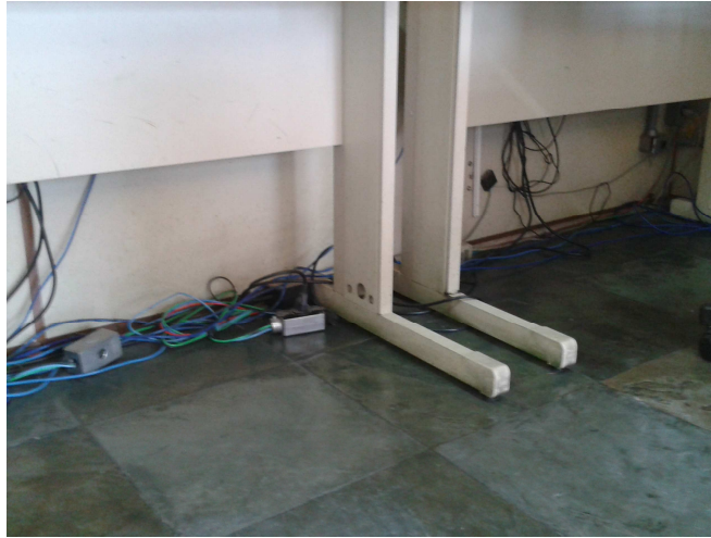
Figura 4: Instalação elétrica sobrecarregada.
