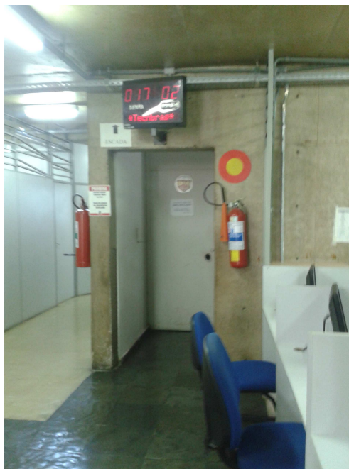
Figura 9: Sinalização incêndio inadequada e insuficiente.
