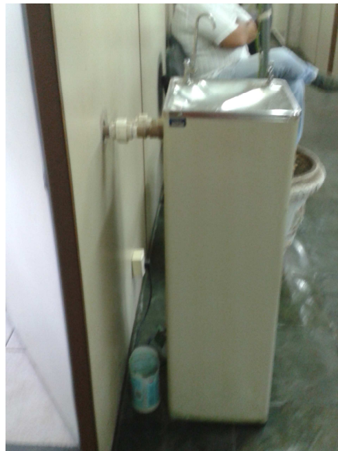
Figura 7: Bebedouro com vazamento.
