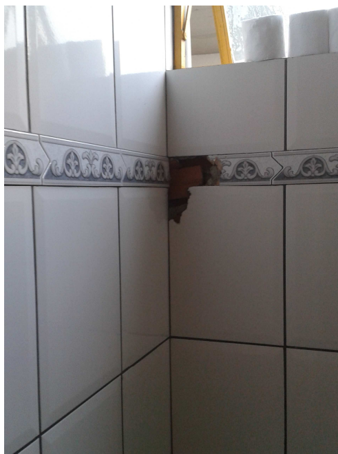
Figura 1: Revestimento interno danificado.
