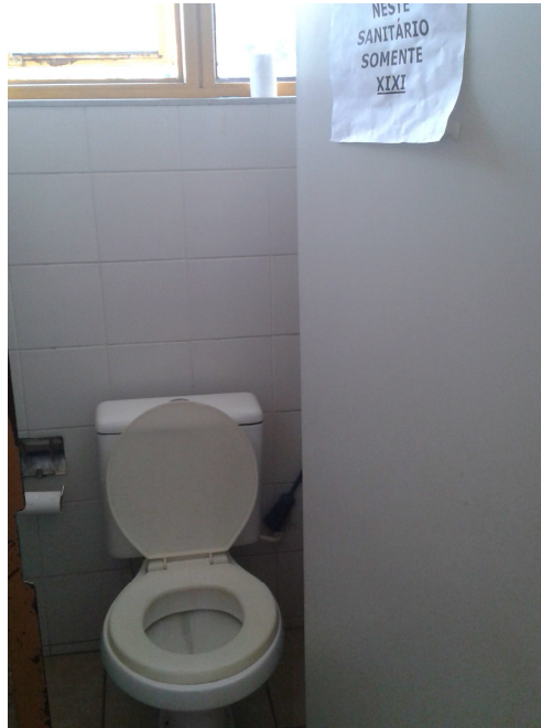
Figura 6: Instalação Sanitária com defeito.
