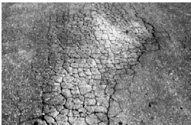
Figura 4.5.2a- Trincas por fadiga do revestimento asfáltico. (FERNANDES JR. et al., 1999 apud CUNHA et al., 2000)
