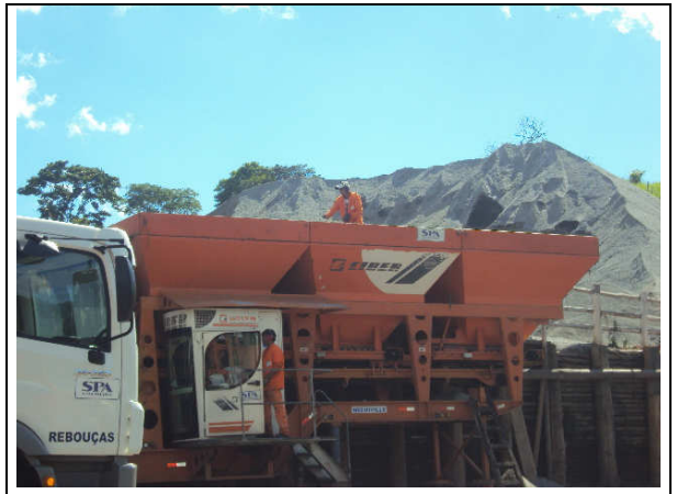
Tanque de despejo dos materiais
