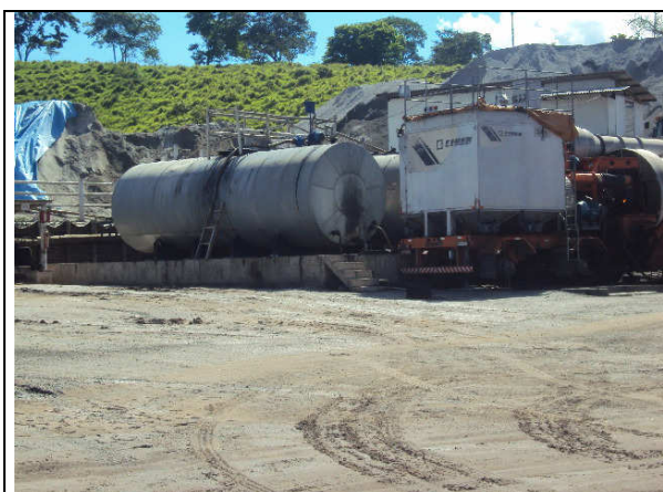
Silo com aditivo “borracha”
