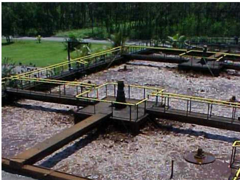
FIGURA 4.7: VISÃO DO TK-02 COM OS AERADORES MENORES
