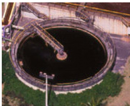
FIGURA 4.3.: VISÃO DO CLARIFICADOR SECUNDÁRIO - CL-02
