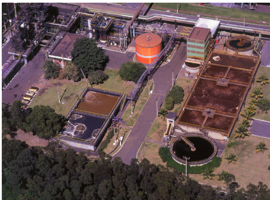
FIGURA 4.1.: VISÃO GERAL DA ESTAÇÃO DE TRATAMENTO BIOLÓGICO DA COMPANHIA SIDERÚRGICA DE TUBARÃO
