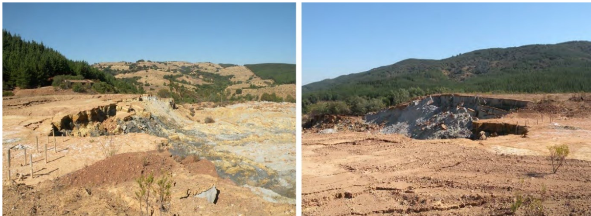
Figura 67 – Fotografias da cunha de ruptura da estrutura de rejeitos Las Palmas; fotografia datada de março de 2010
