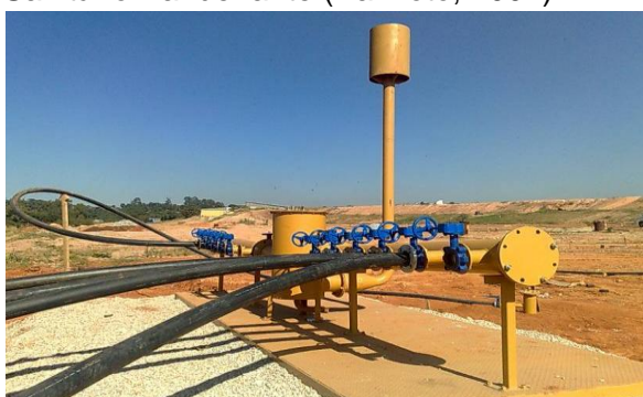
Figura 3.5 - Junção de várias mangueiras saídas dos cabeçotes – redução de tubulações - Aterro Sanitário BR-040 – BH
