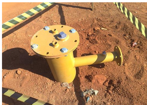
Figura 3.4 - Cabeçote de final de perfuração e conexões para extração de biogás - Aterro BR-040 – BH
