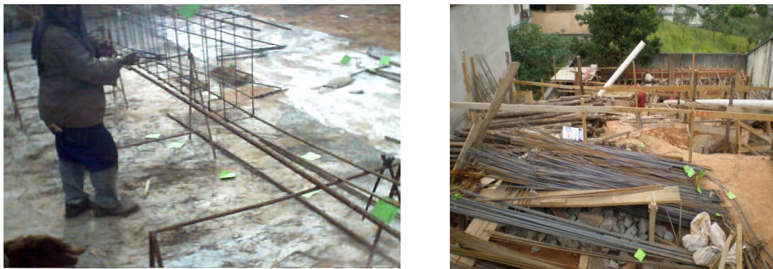
Figura 1.6 – Ambiente de trabalho do armador em um canteiro de obra (Ralf Schuttenberg, 2005)
