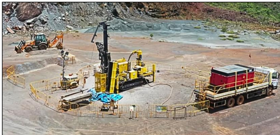
Figura 6 – Exemplo de uma praça de sondagem RC. Fonte: Geosedna Perfurações Especiais S/A
