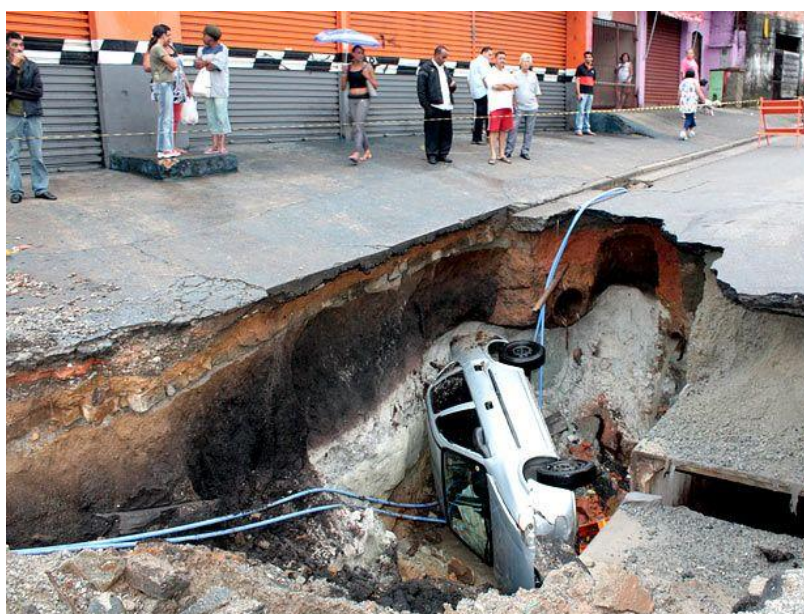
Figura 1.1 – Acidente ocorrido na zona sul de São Paulo, no dia 22/12/2010 (Fonte: Terra)
