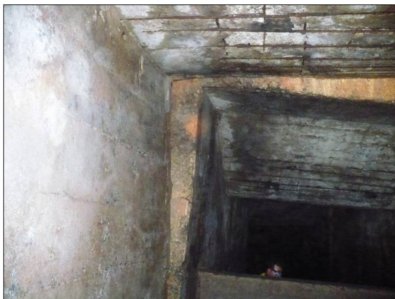
Figura 3.24- Recalque de um dos módulos da galeria da Rua Alvarenga Peixoto (BH)
