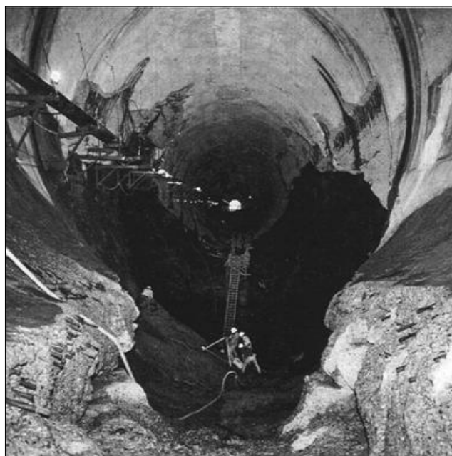
Figura 3. 4 - Efeitos da erosão no túnel da barragem Glen Canyon Dam (Tatro, 2000)
