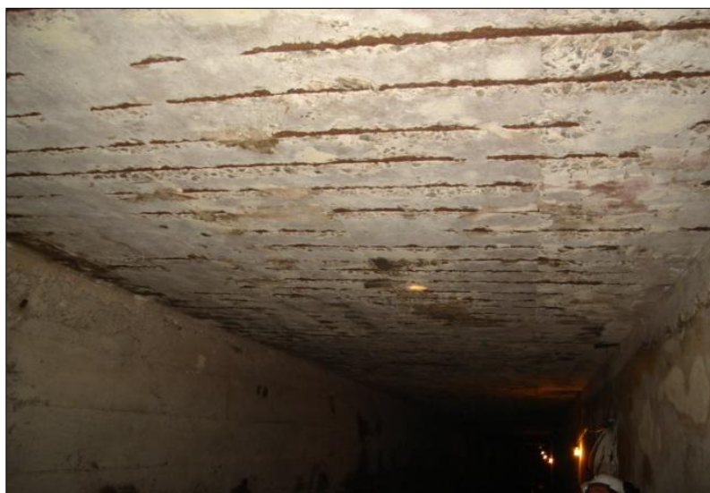
Figura 3.20– A presença gás sulfídrico e a deficiência de cobertura das armaduras propiciaram a severa degradação da laje de teto na galeria da Av. Francisco Deslandes (BH)
