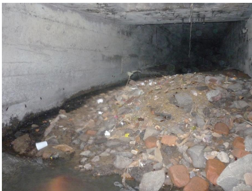
Figura 3.25- Assoreamentos da galeria do Córrego Engenho Nogueira (BH)
