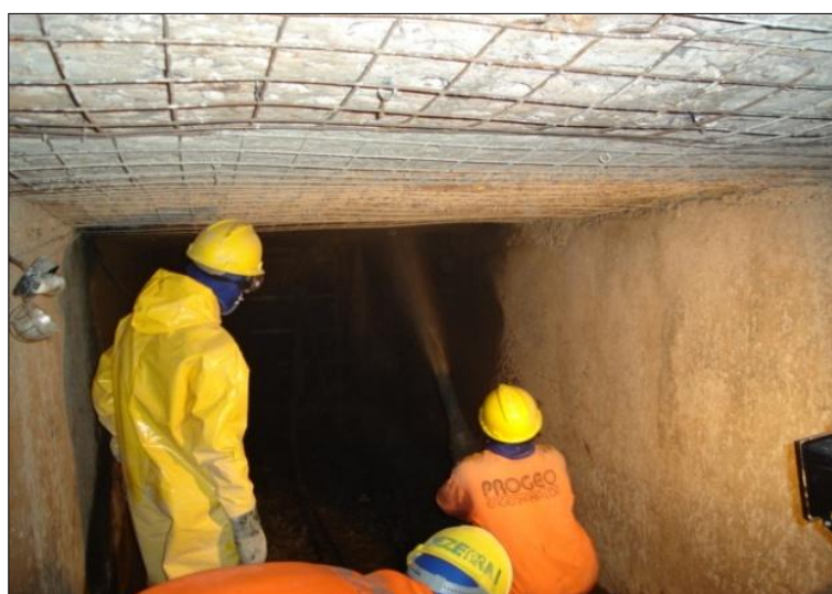
Figura A.2.12 – Reconstituição da laje de teto com concreto projetado, após o tratamento da corrosão das armaduras
