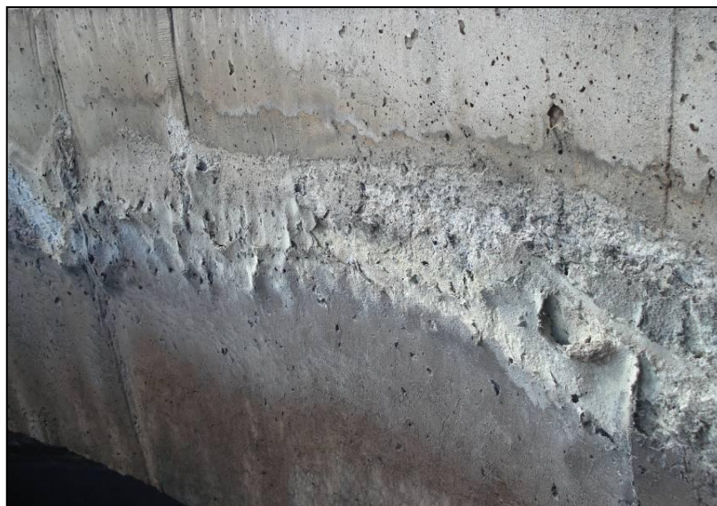
Figura 3. 18 - Degradação do concreto por corrosão biogênica na Estação de Tratamento de Esgoto do Ribeirão da Onça (BH)
