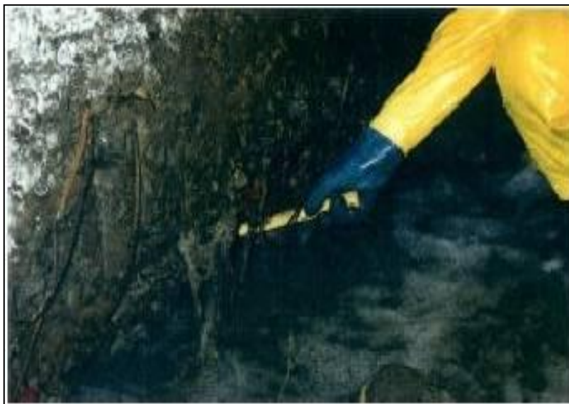
Figura 3.19- A severa degradação corroeu toda a base da parede de concreto da galeria do Córrego da Serra (BH)
