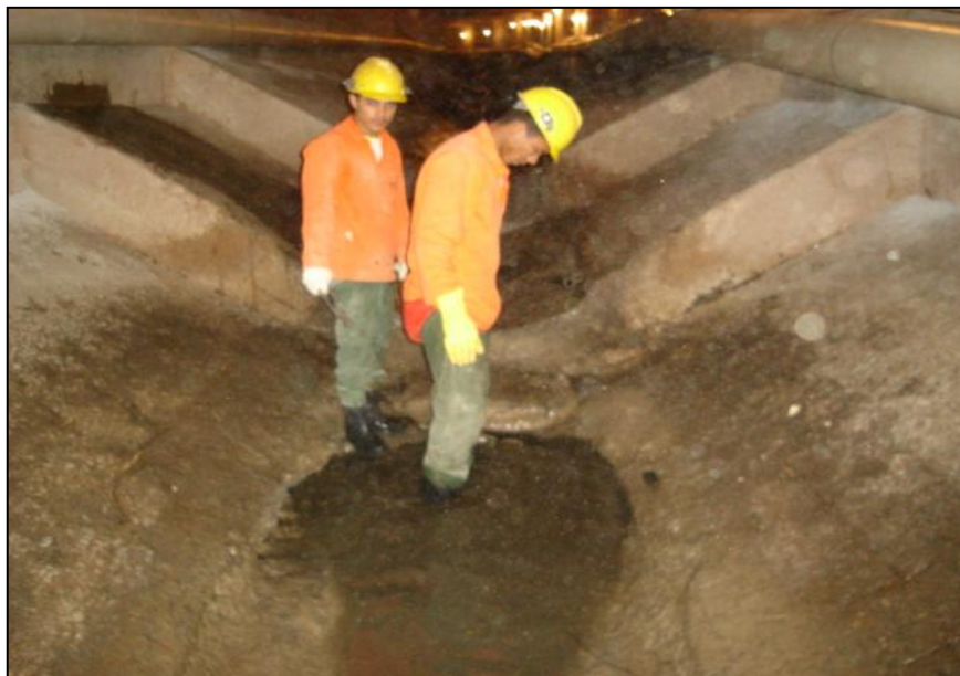
Figura 3.15 – Área com uma erosão por cavitação logo após degraus. Situação observada quando da execução dos trabalhos de recuperação estrutural da galeria da Rua Piauí (BH)
