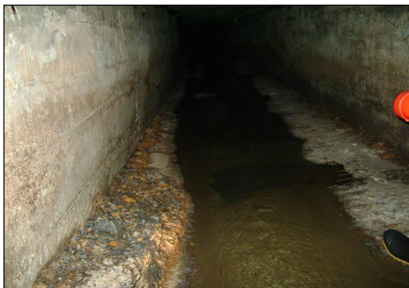
Figura 3.21- Deterioração na laje de fundo devido à abrasão e ataque de sulfatos na galeria da Rua Américo Scott (BH)
