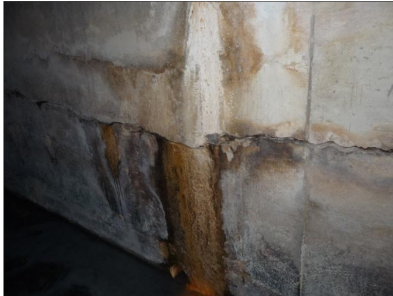
Figura 3.22- Fissuras com infiltrações na parede da galeria da Av. dos Austríacos, em Contagem (MG)
