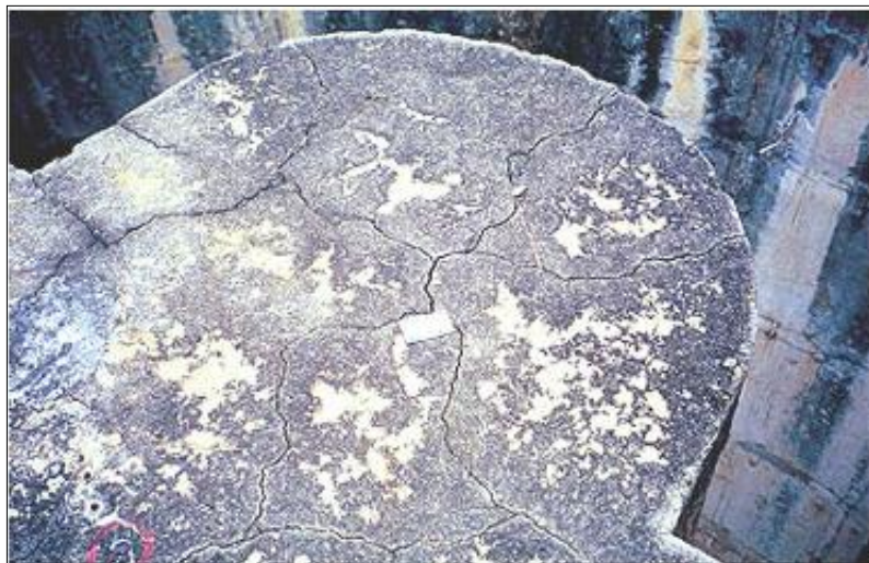
Figura 3. 9 - Topo de pilar de vertedouro de barragem afetado por RAA (Revista Técnica, 2010)
