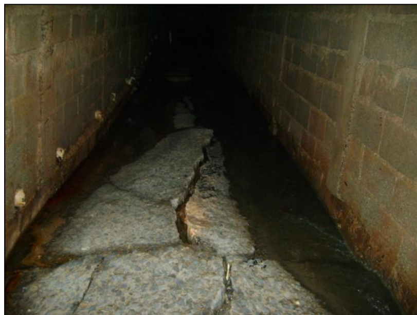
Figura 3.23 – Deformação da laje de piso devido à deficiência de projeto da galeria da Takono (BH)
