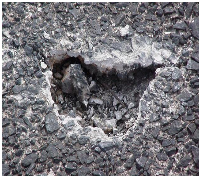
Figura 3. 3 - Efeitos da cavitação em estrutura hidráulica de concreto (Latorre, 2002)
