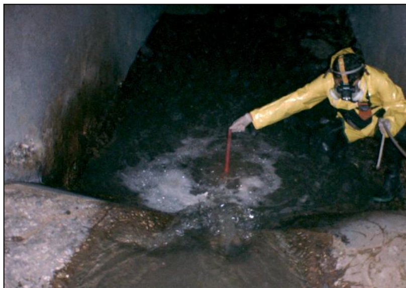
Figura 3.17- Cratera com profundidade superior a um metro após um degrau na galeria do Córrego da Serra (BH)
