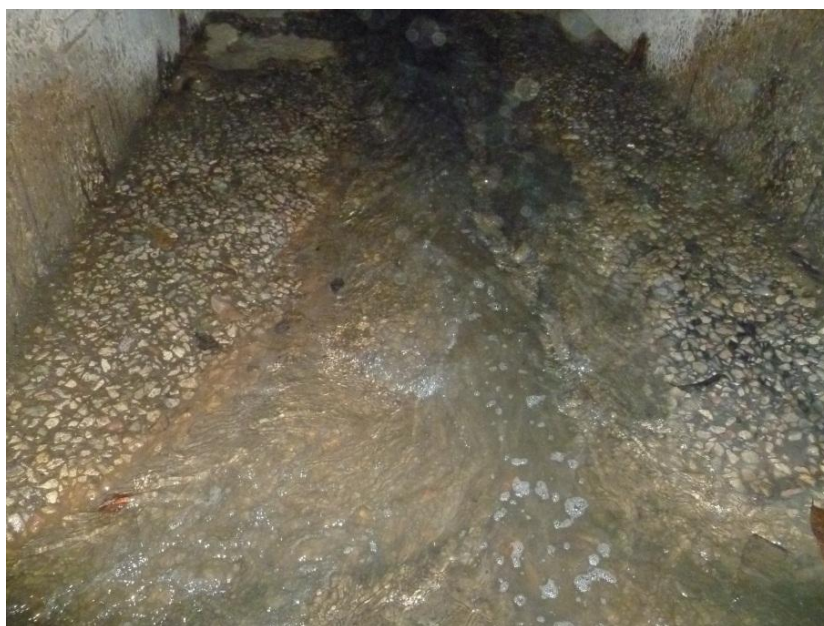
Figura 3. 1 - Erosão por abrasão em estrutura hidráulica de concreto
