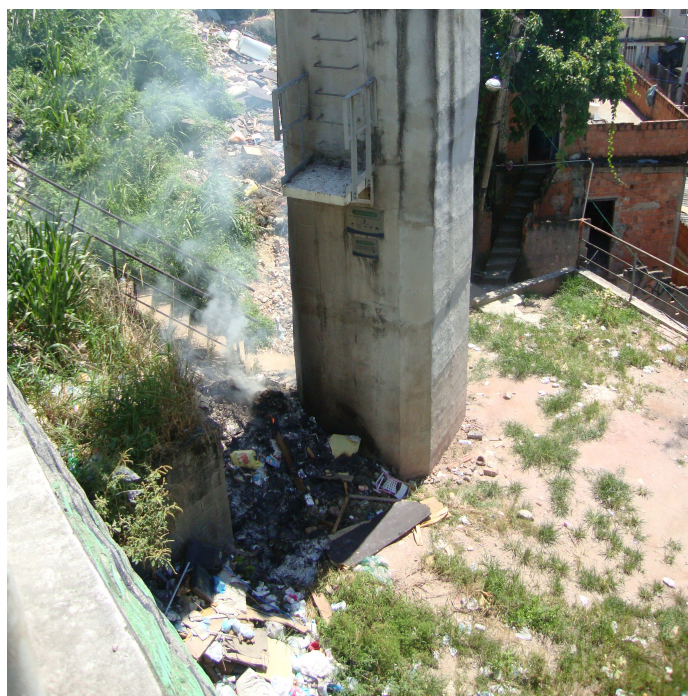
FIGURA 52 – Área de descarte de lixo aos pés dos pilares do Teleférico
