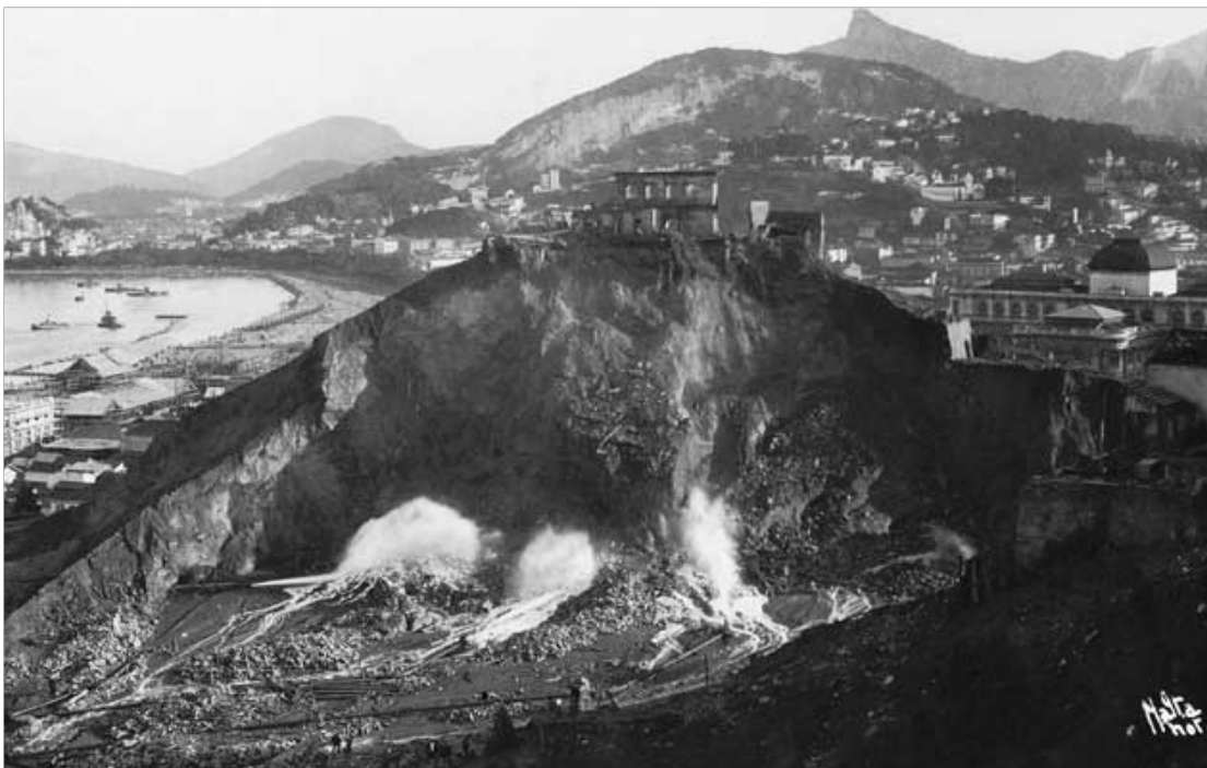
FIGURA 28 – Obras de demolição no Morro do Castelo, no centro do Rio de Janeiro, em 1921
