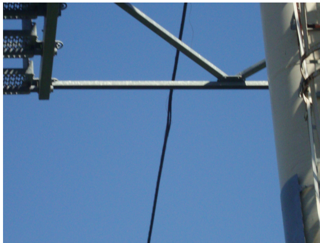
FIGURA 62 – Detalhe do cabo danificado no Teleférico da Providência FONTE: Acervo pessoal da autora.
