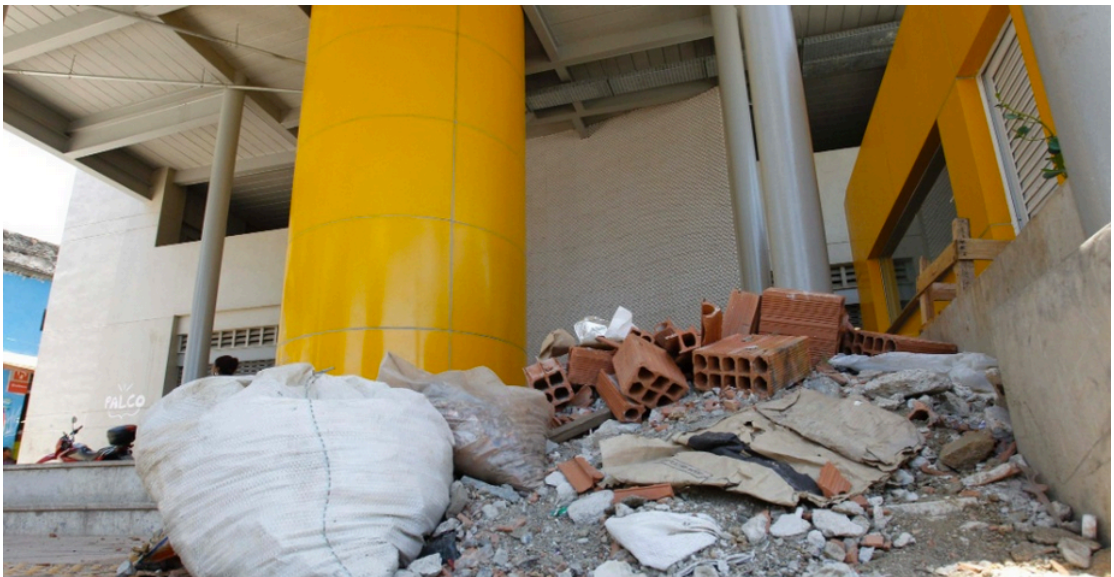
FIGURA 58 – As estações estão abandonadas e servem como depósito de entulhos
