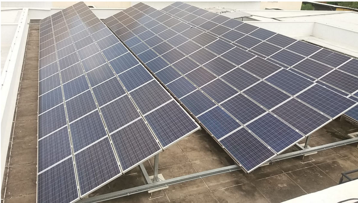
Figura 4.1: Usina solar fotovoltaica Tesla.
