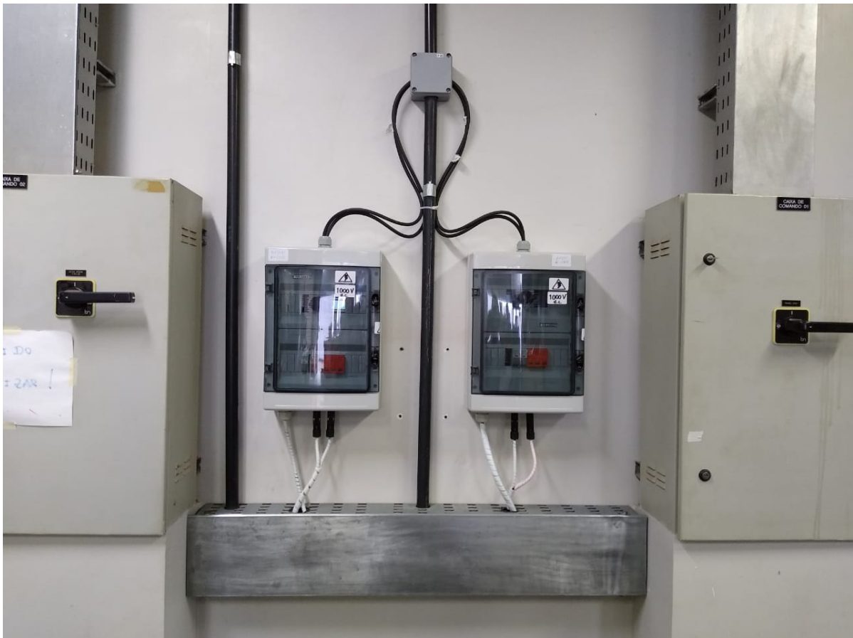
Figura 6.35: String box's para recebimento e seccionamento dos cabos da usina Tesla.
