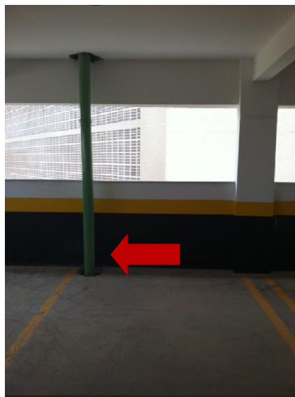
IMAGEM 24. Garagem 2. Furos realizados para execução de uma tubulação hidráulica. Neste caso, ocorreu ainda interferência entre o projeto hidráulico e o projeto arquitetônico, já que a tubulação está locada dentro de uma vaga de veículo.
