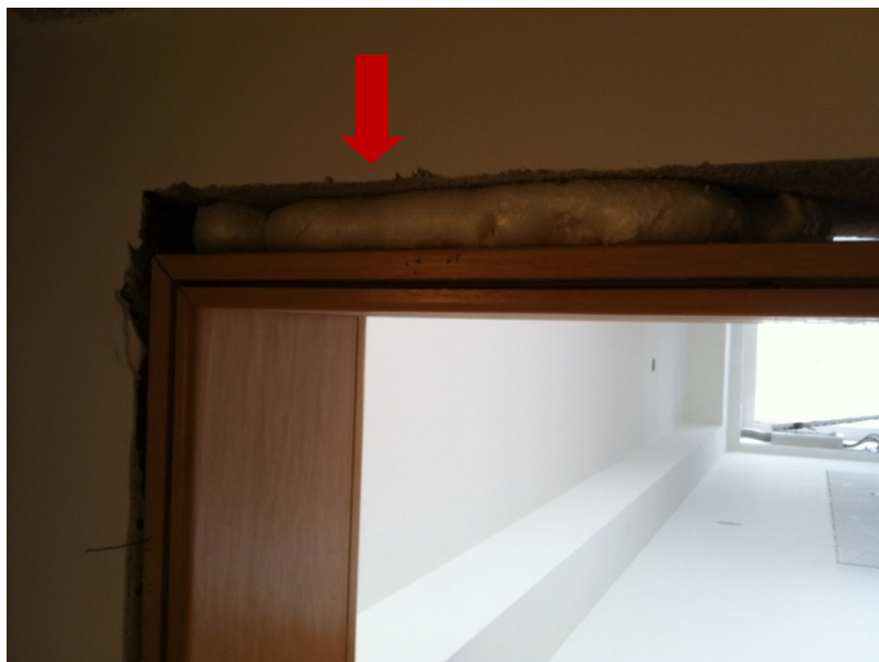
IMAGEM 8. O vão está maior que o necessário, isso demandou uma maior quantidade de espuma expansiva para a instalação do marco da porta. Além disso gerar sobrecusto, o excesso do material gerou um esforço maior que o previsto sobre o marco e o empenou, comprometendo sua funcionalidade da porta.
