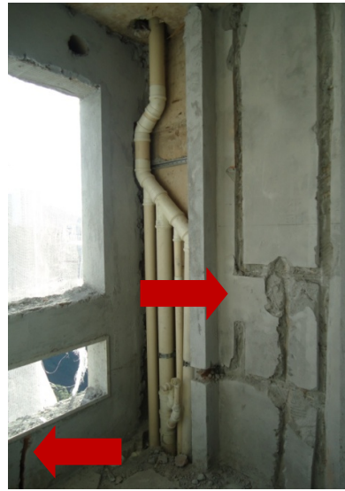
IMAGEM 4. Apartamento. Recortes no reboco para passagem de tubulação hidráulica sem paginação definida. Recorte na alvenaria para passagem de tubulação de gás.
