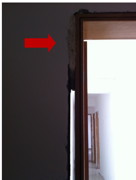
IMAGEM 9. A altura do vão não foi suficiente para a instalação da porta, não sendo possível aplicar a espuma expansiva sobre o marco da porta. Esta espala precisou ser corrigida.
