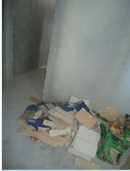
IMAGEM 15. Apartamentos. Perda de cerâmicas utilizada no revestimento destes shafts devido ao grande número de recortes.
