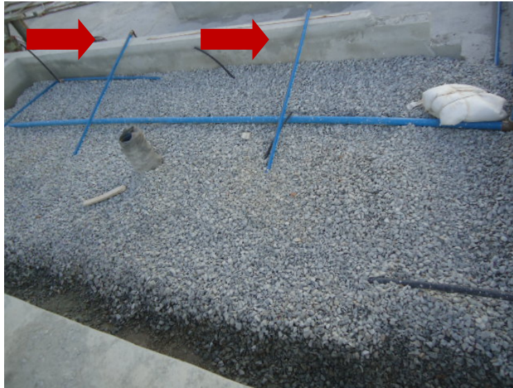
IMAGEM 18. Pilotis. Interferência entre a tubulação do sistema de irrigação e viga invertida.
