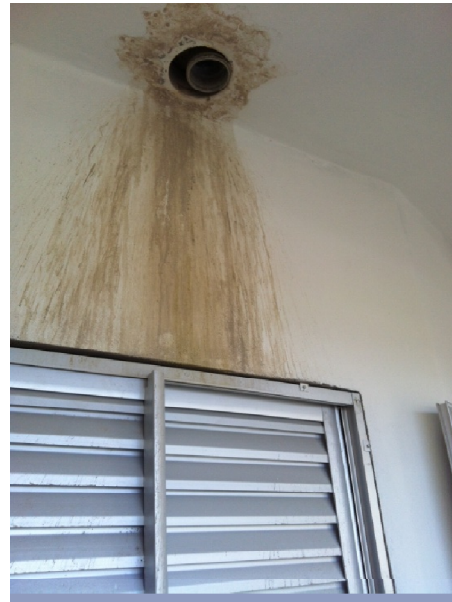
IMAGEM 21. Garagem 1. Furo realizado para passagem de tubulação hidráulica. Neste caso, a pintura do pavimento inferior já havia sido executada e foi danificada. A esquadria instalada também sofreu manchas. Além de não prevista esta passagem, houve um erro na sequência executiva.
