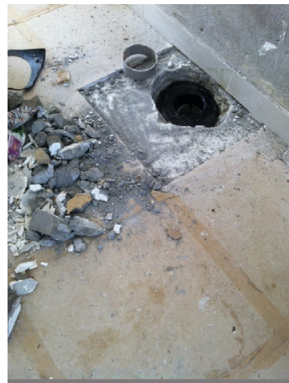
IMAGEM 22b. Pilotis. Por se tratar de um local sem cobertura e sujeito à chuva, foi necessário remover a peça cerâmica e recompor a impermeabilização para evitar possíveis infiltrações.
