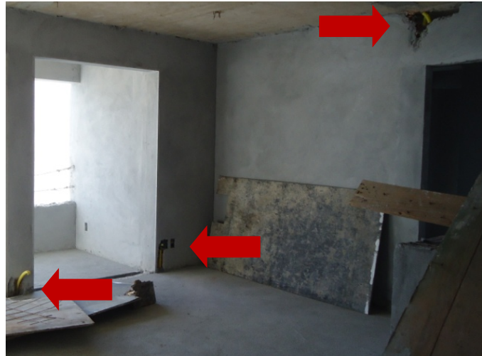
IMAGEM 5. Apartamento. Recortes na alvenaria para passagem de eletrodutos e instalação de caixinhas elétricas.
