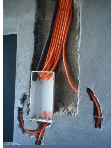
IMAGEM 2. Apartamento. Recortes para passagem de eletrodutos para montagem do QDC e de ponto elétrico sem paginação definida.
