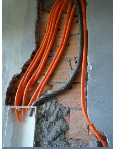
IMAGEM 1. Apartamento. Recortes para passagem de eletrodutos para montagem do QDC sem paginação definida.
