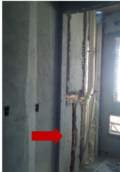
IMAGEM 3. Apartamento. Recortes na alvenaria para passagem de tubulação hidráulica sem paginação definida.
