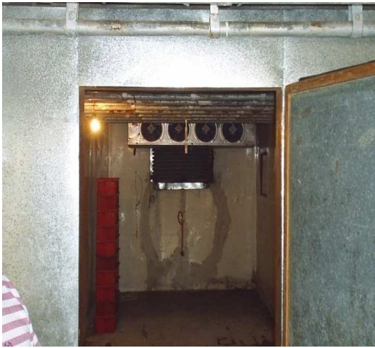
Figura 30. Não conformidade (ausência de estrado em câmara-fria) observada em laticínio que pasteuriza leite e distribui leite em programa governamental.
