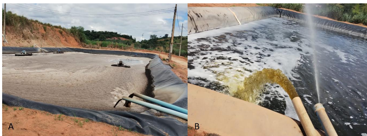
1038 Figura 05: Estação de Tratamento de Efluentes (ETRA). A) Reator biológico. B) - Lagoa para armazenar a 1039 água de reuso depois do tratamento. Fonte: Elaborado pela autora 1040
