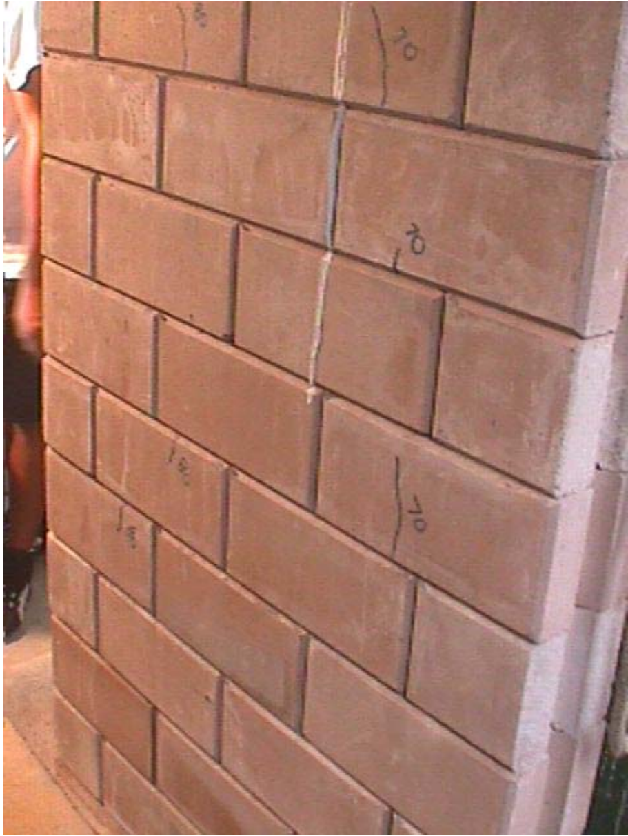
Figura 11.7 – Fissuração em P3 de [3x15] – face sul superior
