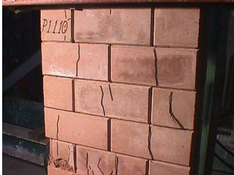
Figura 11.4 – Fissuração em P1 de [2x10] – face sul superior
