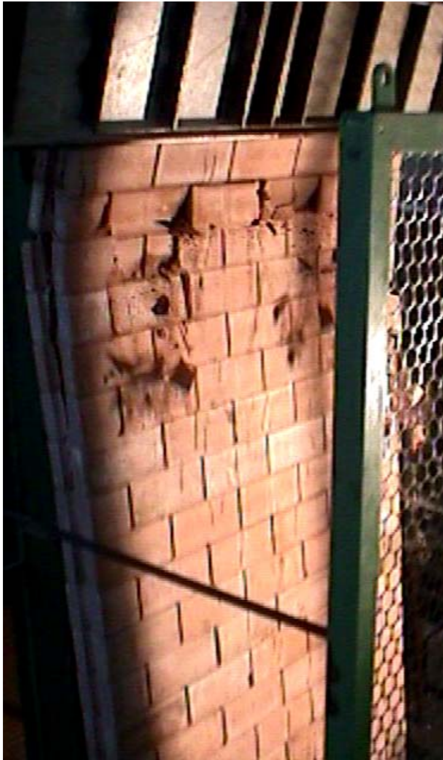
Figura A36 – Início da queda da parede P2 com 24 fiadas. Observa-se o esmagamento em alguns tijolitos e a ruptura do septo central na parte superior da parede
