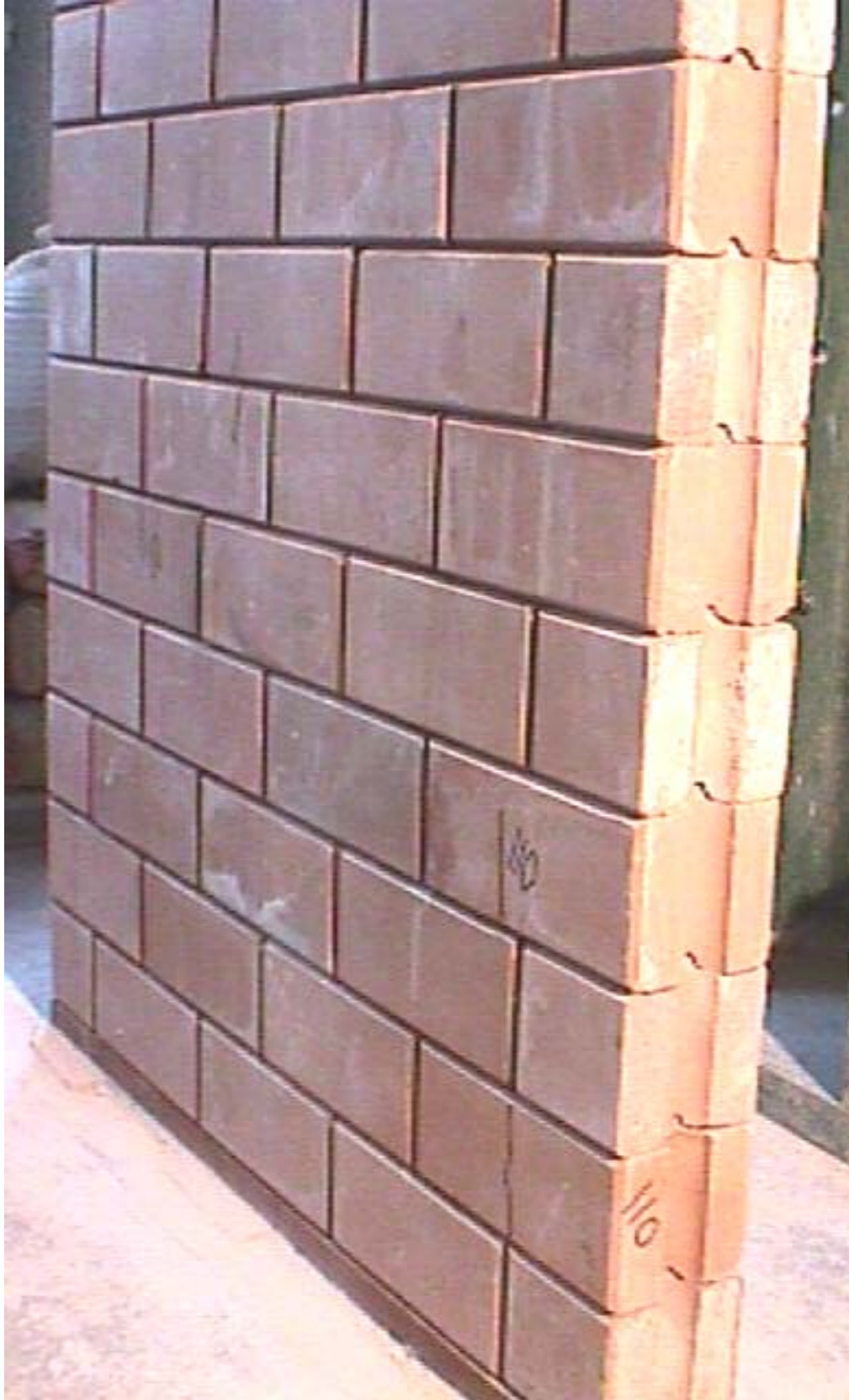
Figura A30 – Fissuração da parede P3 com 20 fiadas, face sul parte inferior
