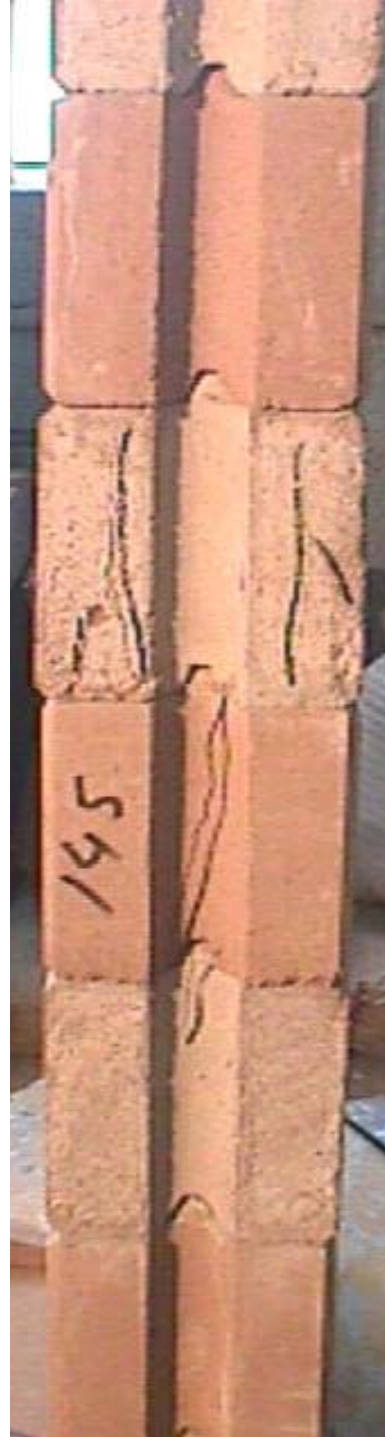
Figura A23 (à direita) – Detalhe da face leste da parede P1 com 15 fiadas, após a carga máxima
