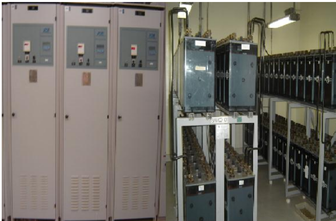
Figura 3.13 - À direita: três carregadores de baterias. À esquerda: dois bancos de baterias.
