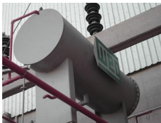
Figura 3.31 - Tanque de expansão do transformador elevador.
