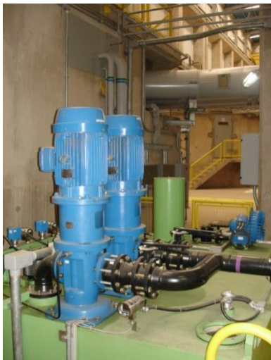
Figura 3.16 - Bombas do mancal de escora.
