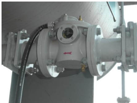
Figura 3.32 - Relé de gás.
