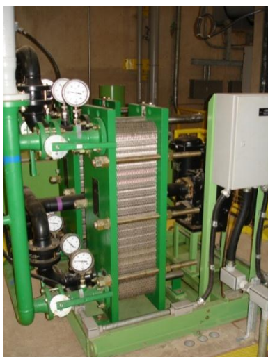
Figura 3.17 - Trocadores de calor do mancal de escora.
