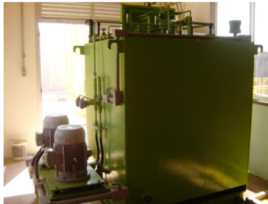
Figura 3.45 - Central óleo-dinâmica do vertedouro.
