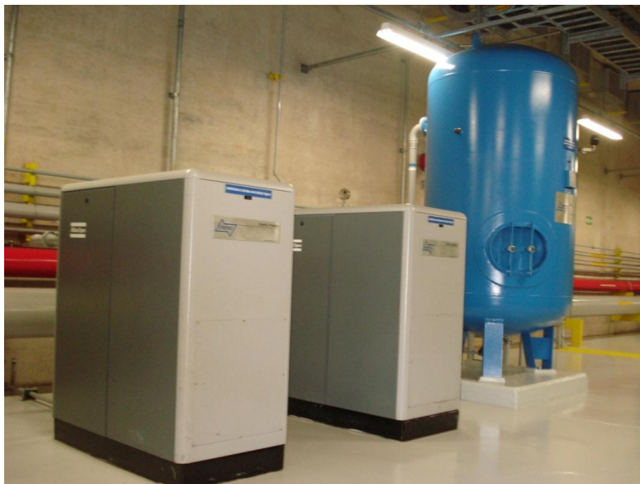
Figura 3.36 - Compressores e tanque de ar comprimido.
