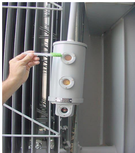
Figura 3.30 - Desumidificador do transformador elevador.
