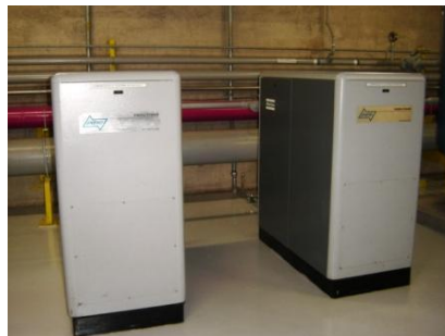
Figura 3.21 - Compressores para o sistema de regulação de velocidade.
