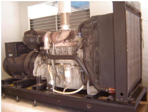
Figura 3.47 - Grupo gerador a diesel de emergência.
