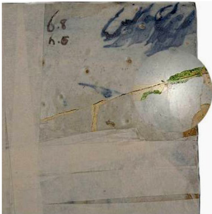
Fig. 9. Azulejos da parede sul do claustro do Convento de Santo Antônio do Recife, PE. com indício de contaminação fúngica.
